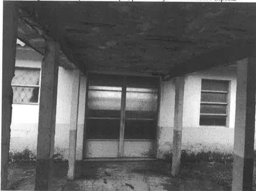
Imagem 13: Situação da circulação, pilares e laje com armadura exposta
