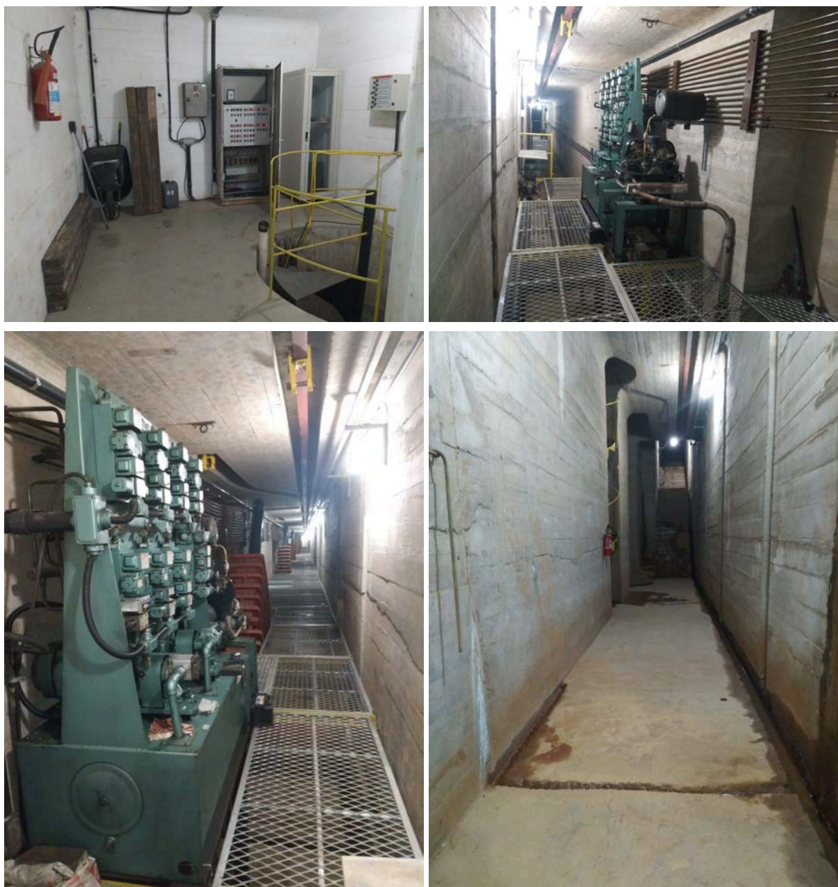
Figuras 05 à 08 - Interior da Barragem - Painel elétrico, controle hidráulico e galeria interna
