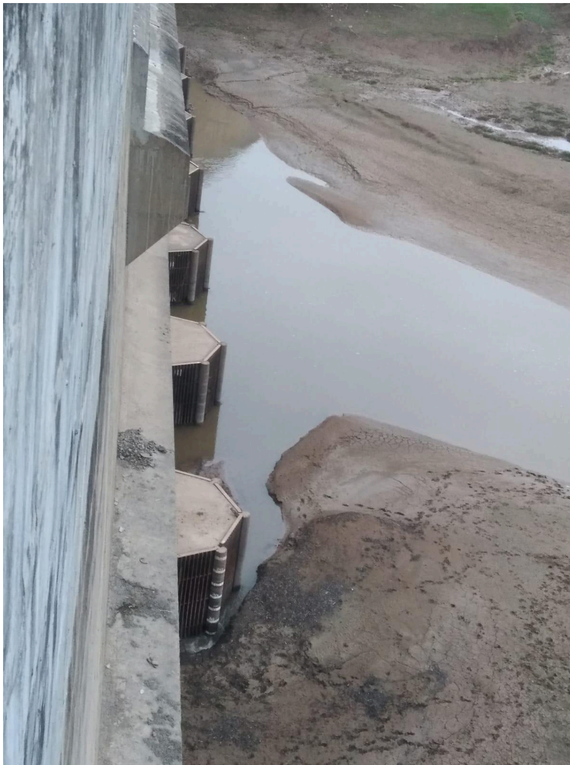
Figura 12 - Entrada d'água das comportas
