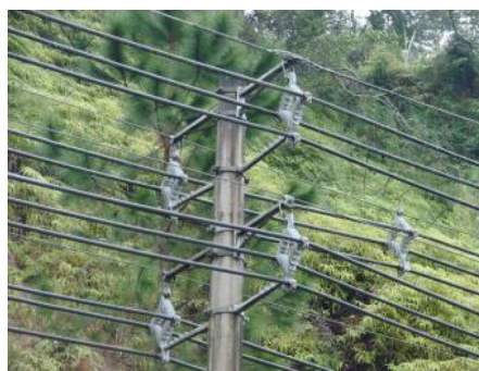
Figura 2 – Rede Compacta Cabos Protegidos
