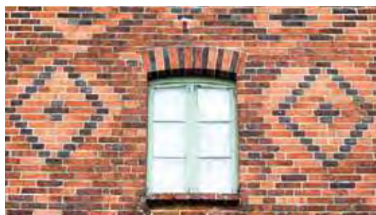
Empena do Salão Hammermeister, com desenhos geométricos formados a partir da colocação de tijolos de tonalidades diferentes
