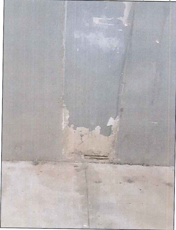
Figura 28 – Pilar com armadura exposta (Quadra)
