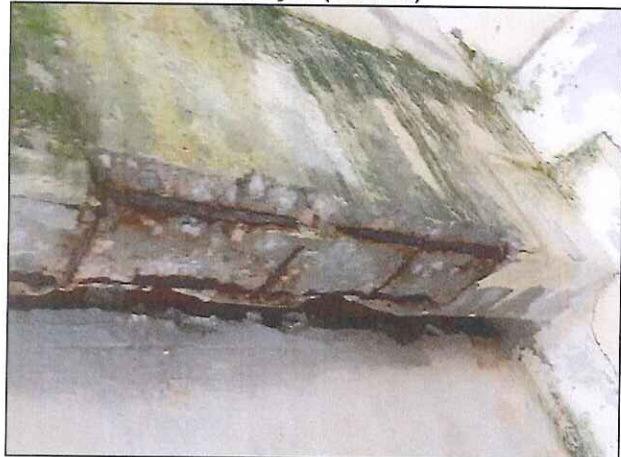
Figura 16 – Viga em estado crítico, com armadura exposta e oxidada, seção de concreto comprometida e infiltração (Quadra)
