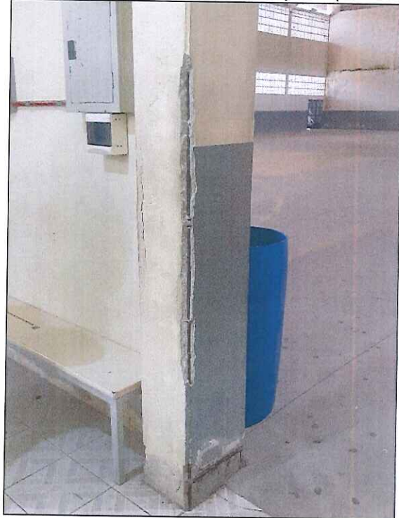
Figura 19 – Pilar com armadura exposta (Quadra)
