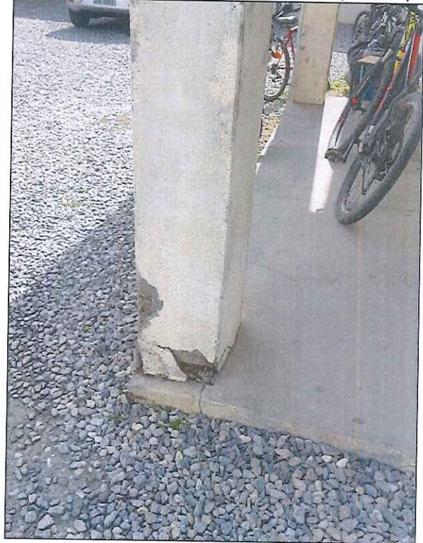
Figura 29 – Pilar com armadura exposta (Bloco 1)
