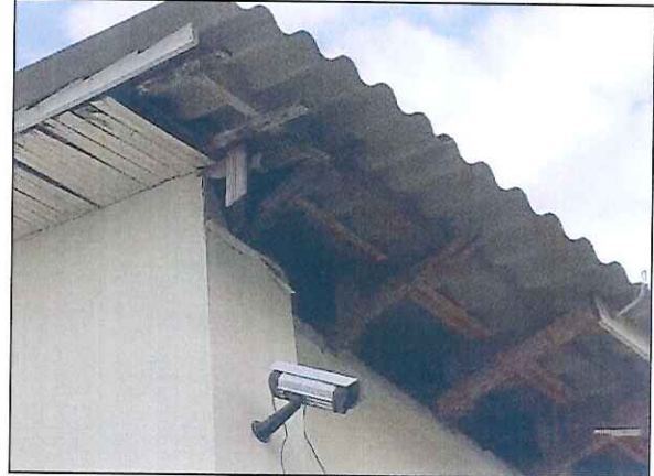
Figura 7 – Cobertura trocada recentemente e deixada sem calha com madeiramento danificado (Bloco 2)
