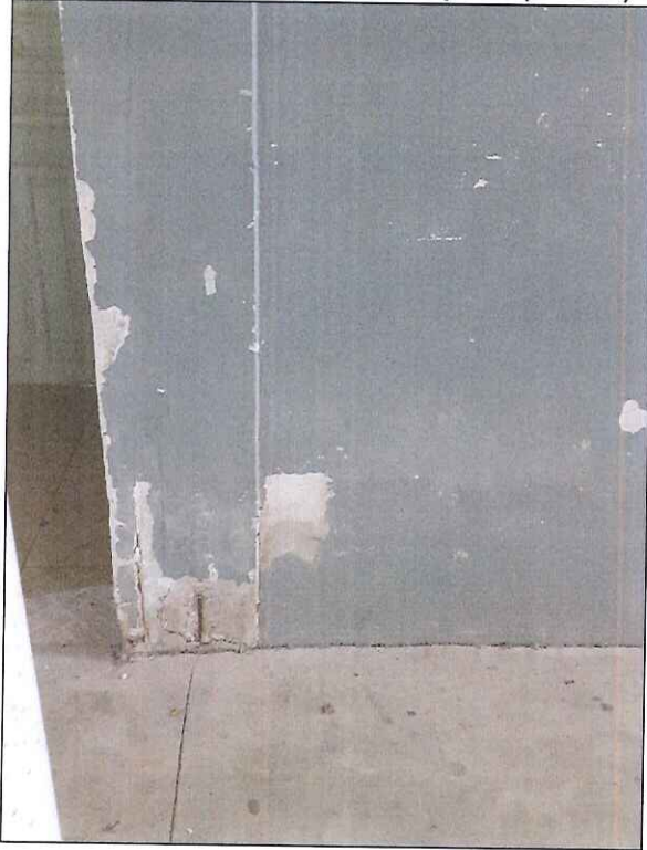
Figura 24 – Pilar com armadura exposta (Quadra)
