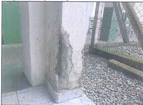
Figura 2 – Pilar perto da cozinha com armadura exposta, oxidada e seção do concreto comprometida (Bloco 2)
