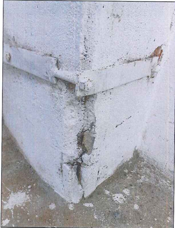
Figura 14 – Estrutura de concreto do pilar rachada (Quadra).
