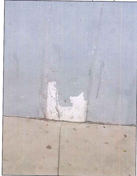
Figura 27 – Pilar com rachadura (Quadra)
