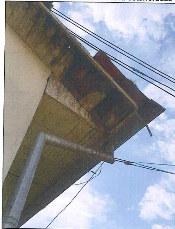
Figura 30 – Estrutura de forro e cobertura deterioradas (Bloco 1)
