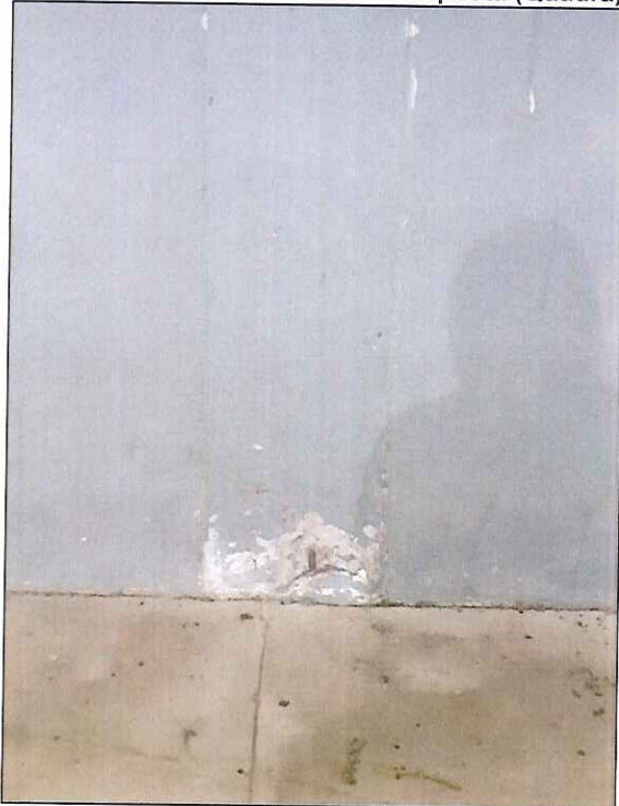
Figura 26 – Pilar com armadura exposta (Quadra)
