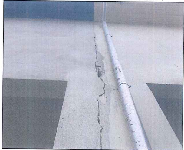
Figura 4 – Rachadura Pilar, possível ponto de junta entre estruturas construídas em tempos diferentes (Bloco 2)
