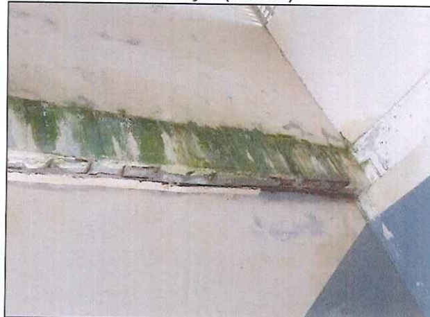
Figura 17 – Viga em estado crítico, com armadura exposta e oxidada, seção de concreto comprometida e infiltração (Quadra)
