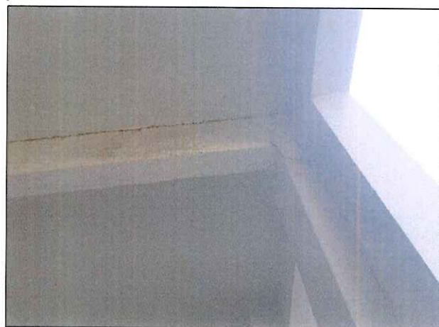
Figura 3 – Fissura entre a viga e laje (Bloco 2)
