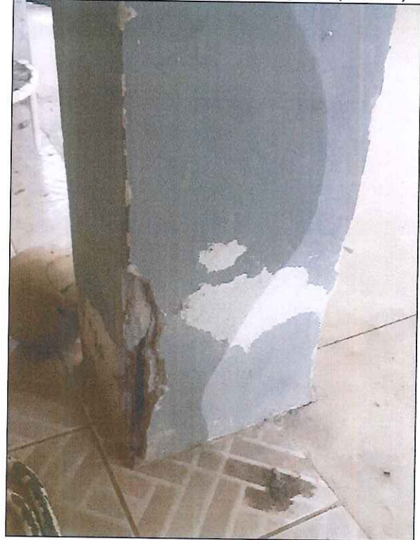
Figure 25 – Pilar com armadura exposta (Quadra)
