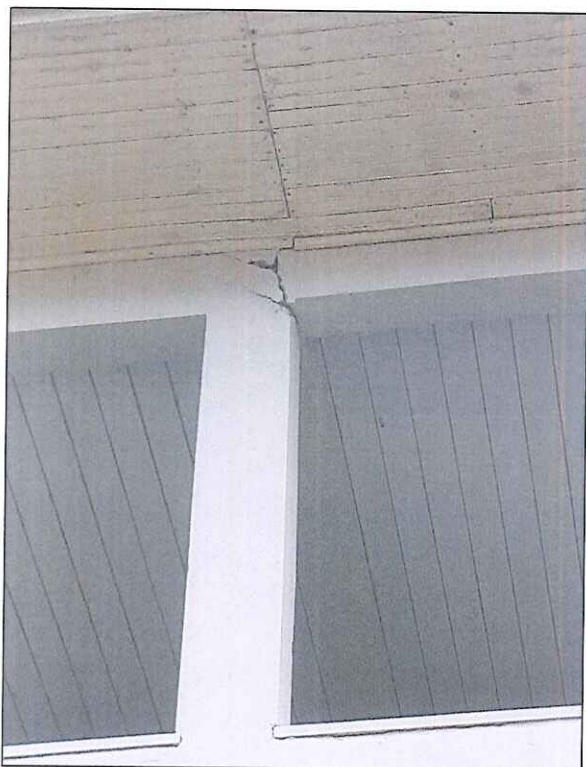
Figura 5 – Rachadura entre viga e pilar (Bloco 2)
