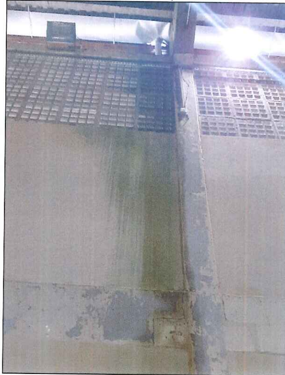
Figura 15 – Calha danificada gerando infiltração nas paredes internas (Quadra).
