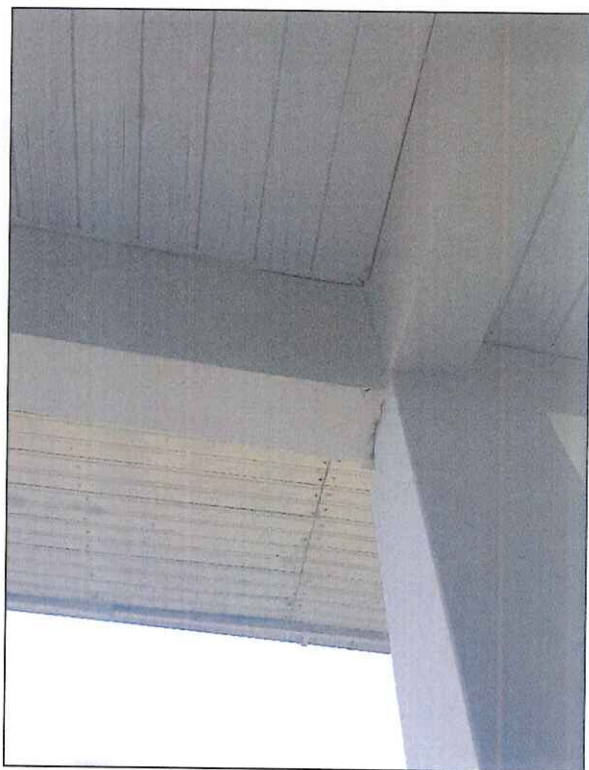
Figura 6 – – Rachadura entre viga e pilar (Bloco 2)
