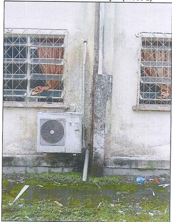
Figura 9 – Ar-condicionados não operantes, devido a falta de capacidade na rede interna, problemas de umidade e infiltração (Bloco 2)
