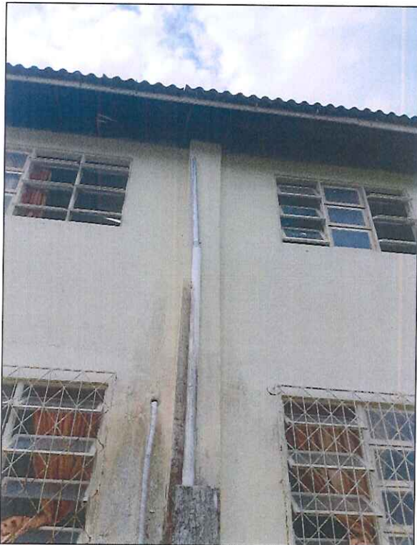
Figura 8 – Descidas pluviais sem uso (Bloco 2)
