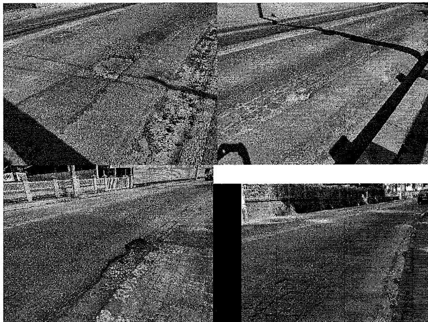
Vista aérea de parte da Hermann Hering e situação da camada asfáltica na atualidade.
