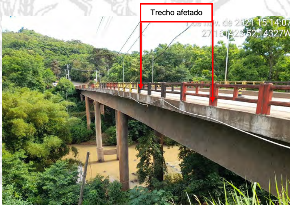
Foto 20: Região onde apresentam-se maior número de fissuras
