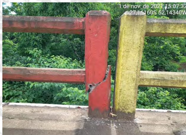
Foto 35 – Rompimento do Guarda Corpo
