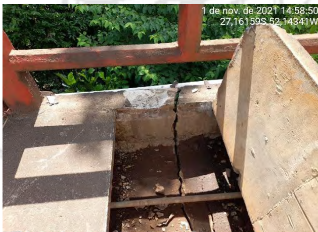
Foto 34 – Fissuras / Trincas - Tabuleiro
