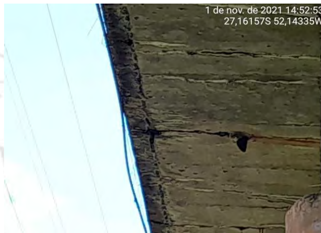
Foto 26 – Fissuras no Bordo - Jusante
