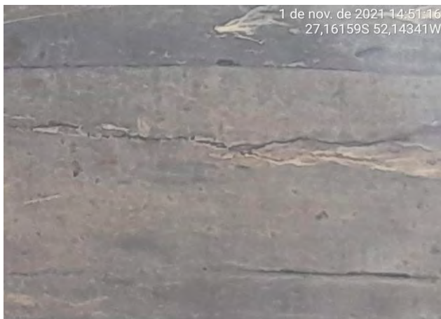
Foto 25 – Fissuras na Laje Central
