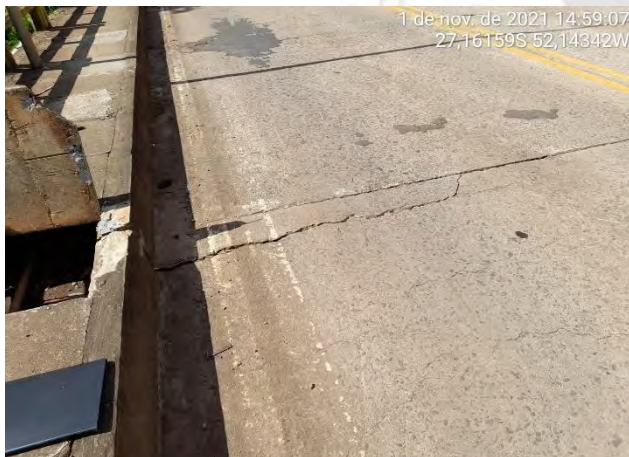
Foto 21 – Fissuras na Pista de Rolamento
