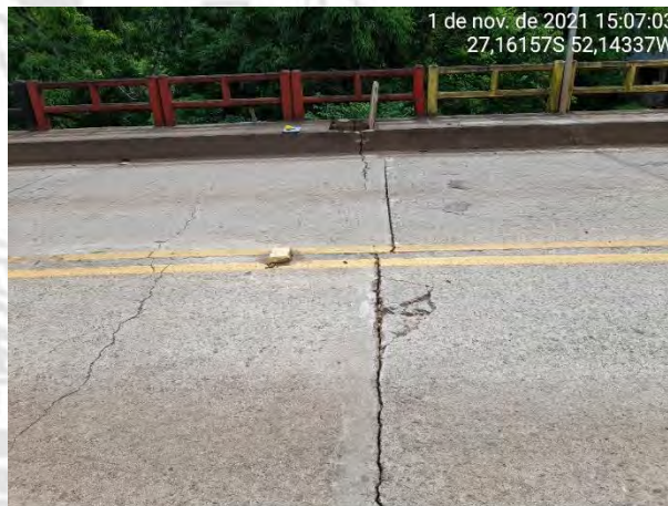
Foto 22 – Fissuras na Pista de Rolamento
