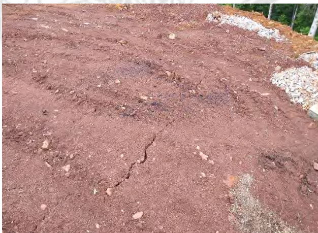
Foto 06 – Aterro Lateral – Sem compactação
