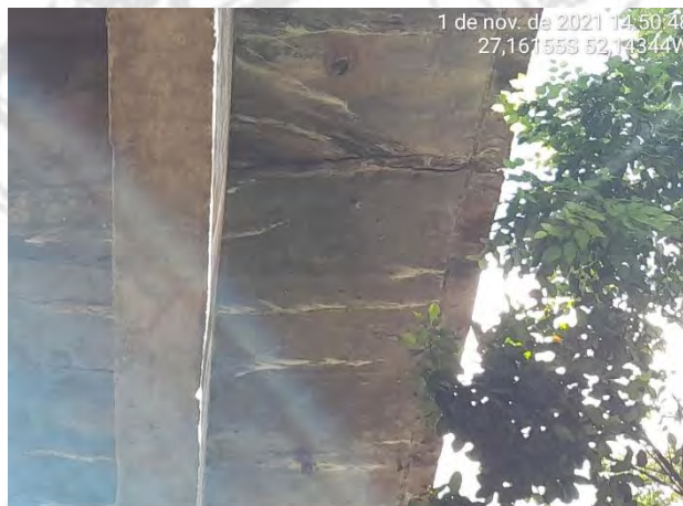
Foto 24 – Fissuras no Bordo - Montante
