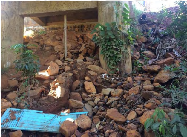
Foto 04 – Talude sem o Aterro Lateral
