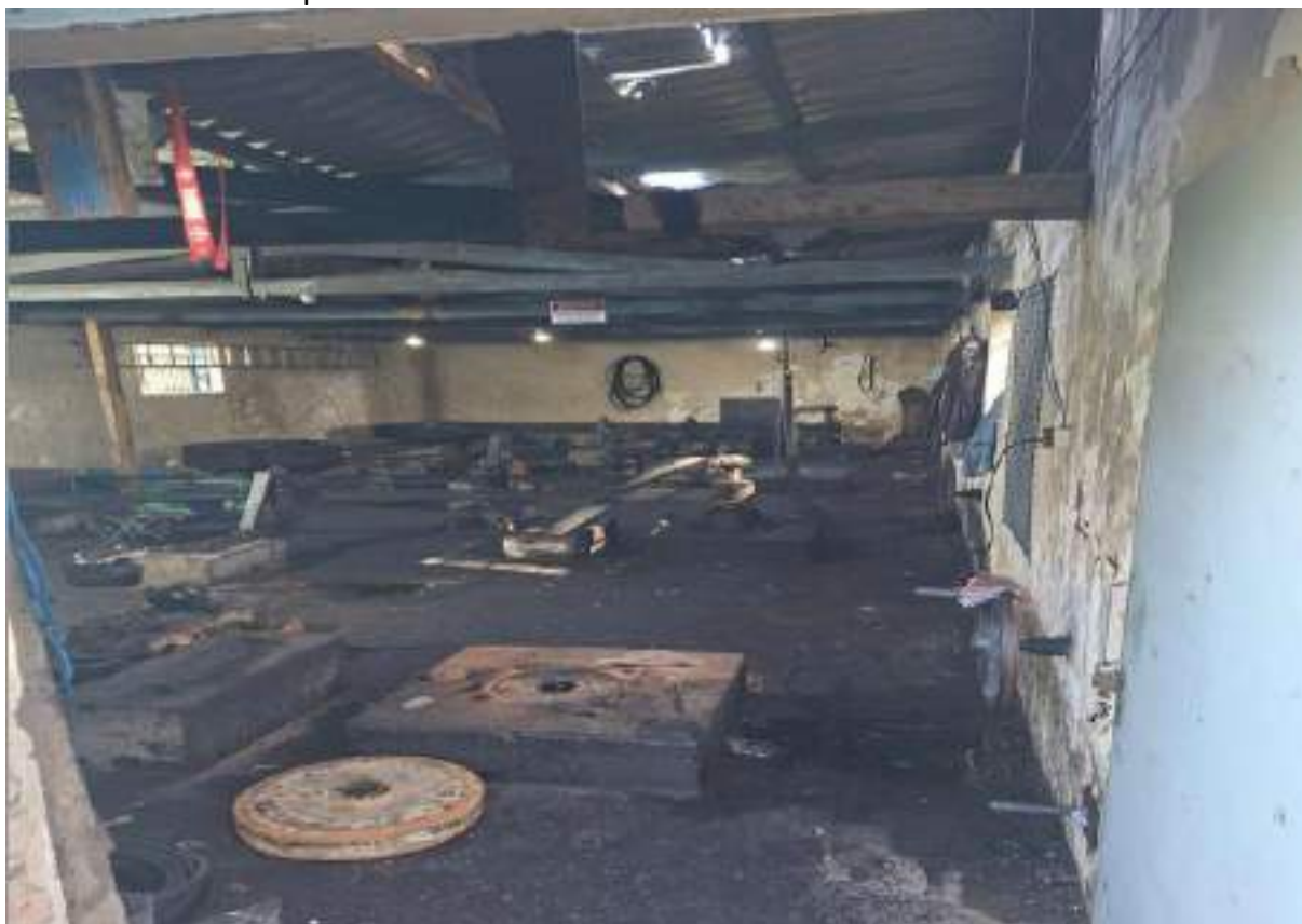
Foto 02: Interior casa de máquinas, sistema do bombeamento
