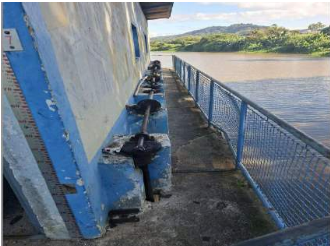
Foto 05: Sistema de eixos para abertura e acionamentos de comportas
