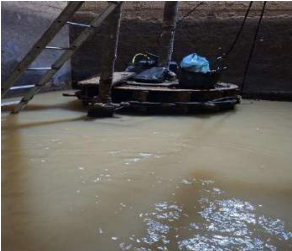
Foto 03: Poço com turbina de captação sistema hidráulico
