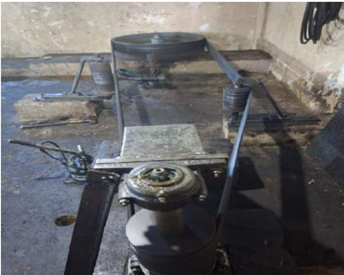
Foto 04: Sistema de bolias, eixo turbina, travas e acionamentos hidráulicos
