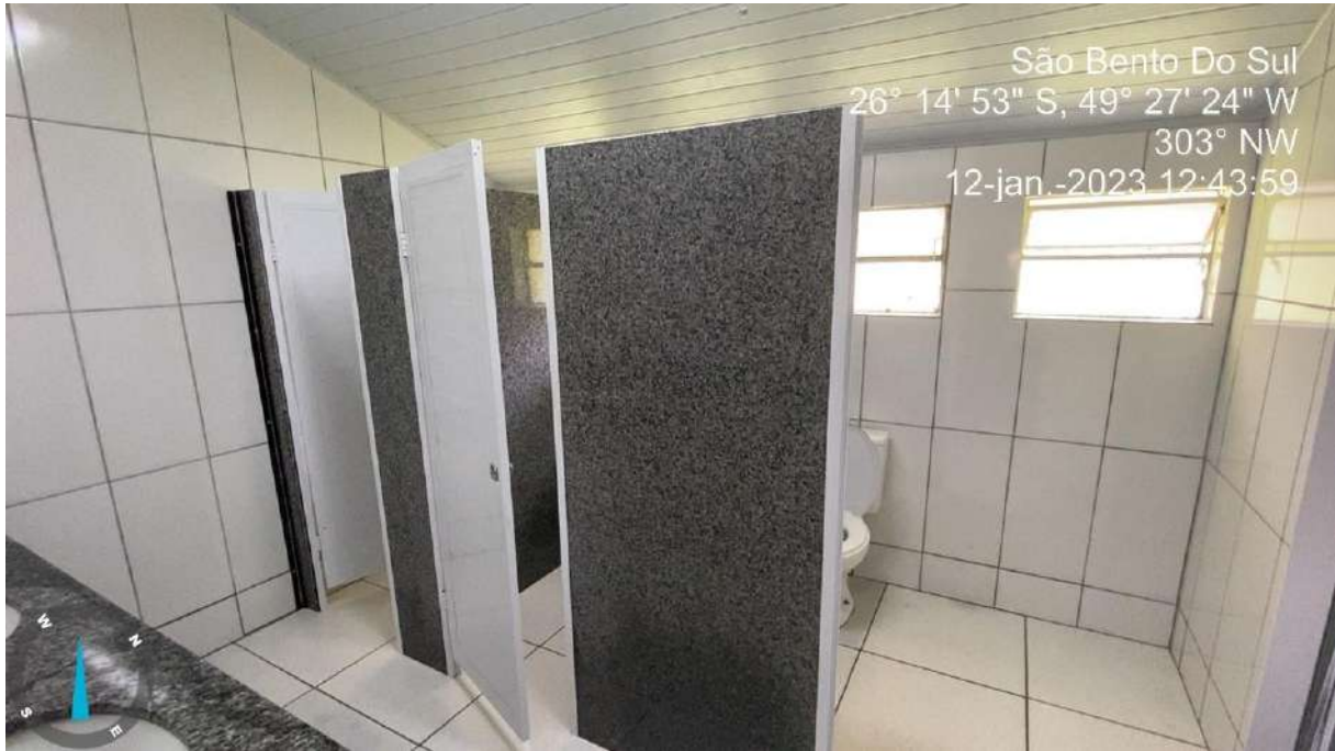
Foto 11 – Banheiro masculino, já adaptado para PCD
