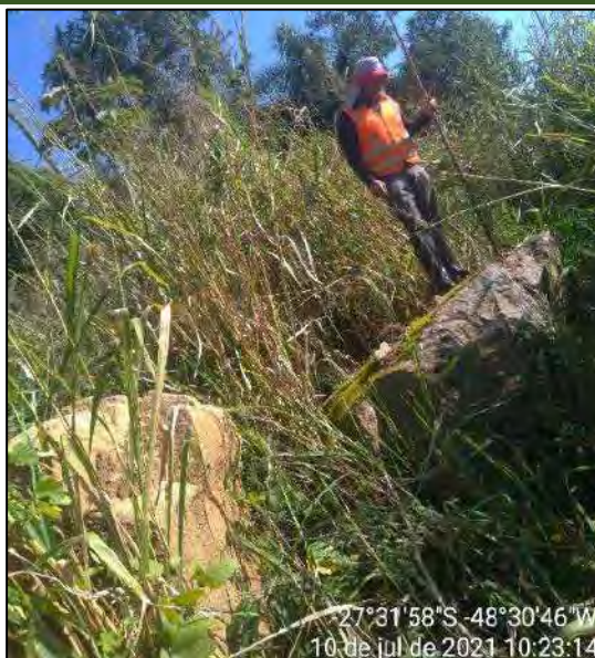
Figura 3.2 19 - Blocos de rocha desprendidos no pé do taludem próximos ao km 13+500
