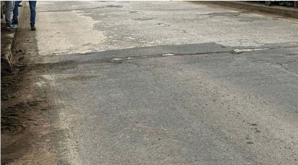
Imagem 52 - encontro cabeceira ponte lado Três Barras (recalque por perda de solo na contenção e ausência da laje de aproximação).
