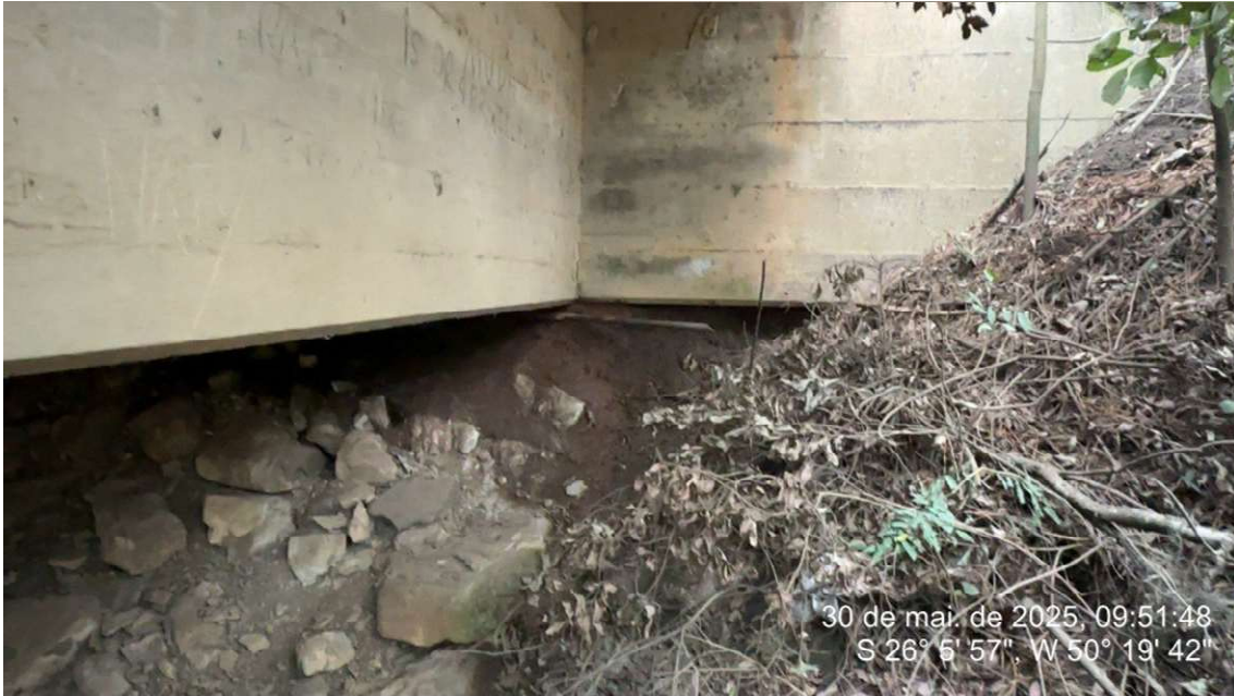
Imagem 51 - Detalhe da contenção nas cabeceiras (perda de solo por erosão).
