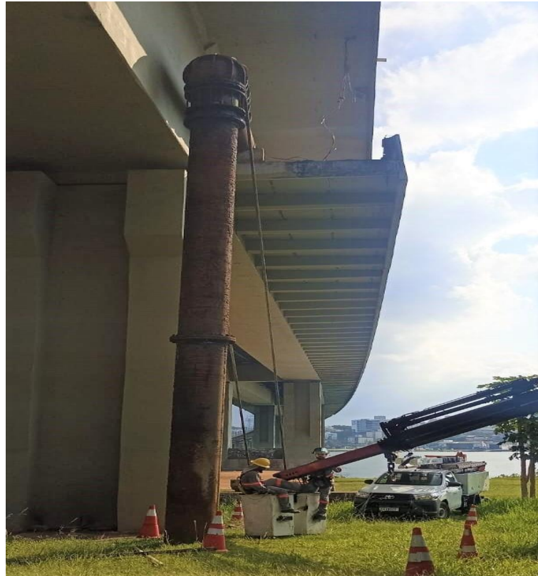
Figura 17 - Saída da adutora na ponte Colombo Salles, lado norte, cabeceira da ilha
