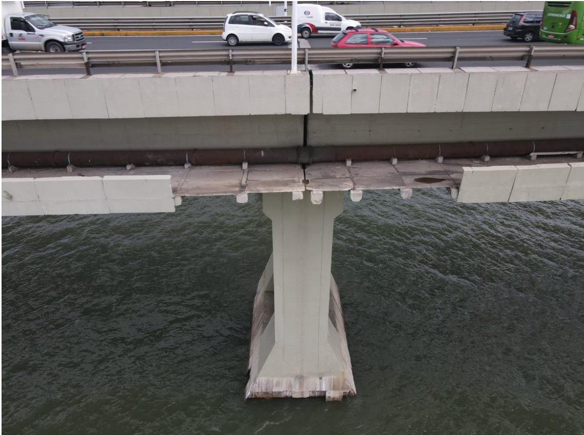
Figura 10 - Lado norte: placas pré-moldadas que serviam de guarda-corpo da passarela ausentes. Adutora apoiada nas vigas da passarela.
