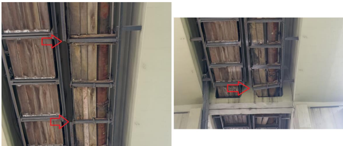
Figura 29 - Passarela metálica de serviço: Barra longitudinal descontinuada (esq.) / Barra transversal solta (dir.)
