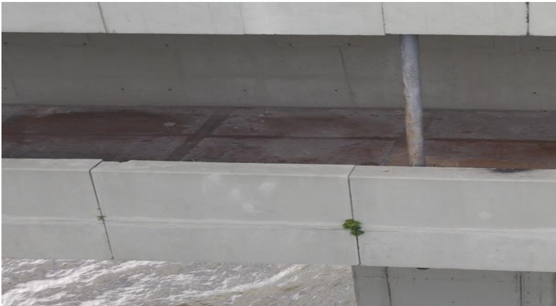
Figura 36 - Placa do guarda-corpo com crescimento de vegetação nas juntas entre as placas
