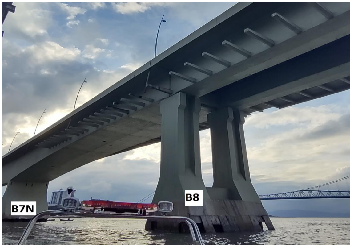
Figura 25 - Vista da ilha: vigas da passarela voltam a ter recorrência no vão entre o Bloco 7N e 8
