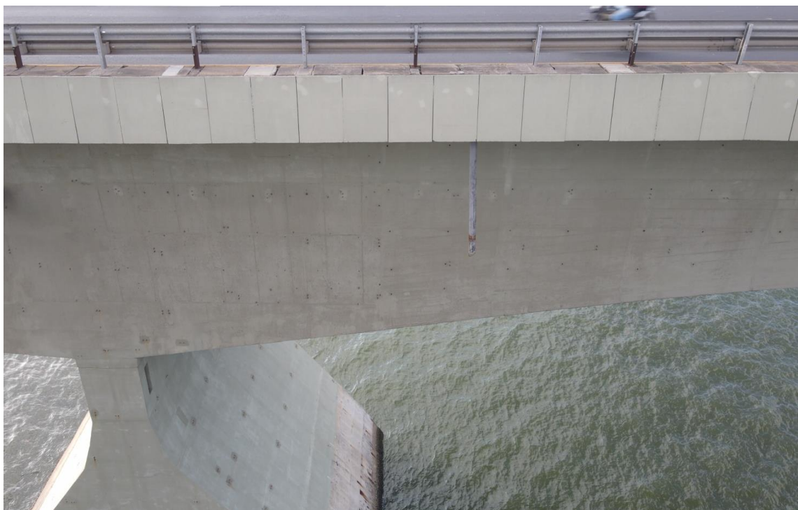
Figura 24 - Trecho sem elementos da passarela, no vão entre os Blocos 7 e 7N
