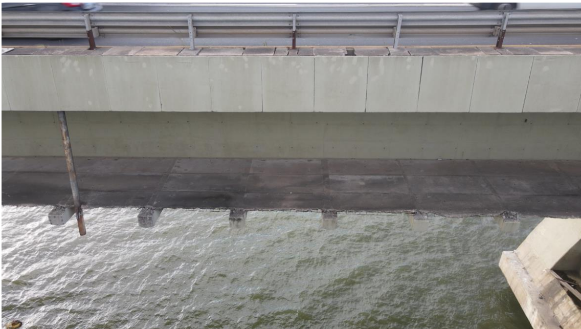
Figura 20 - Trecho da passarela sem guarda-corpos, lado sul
