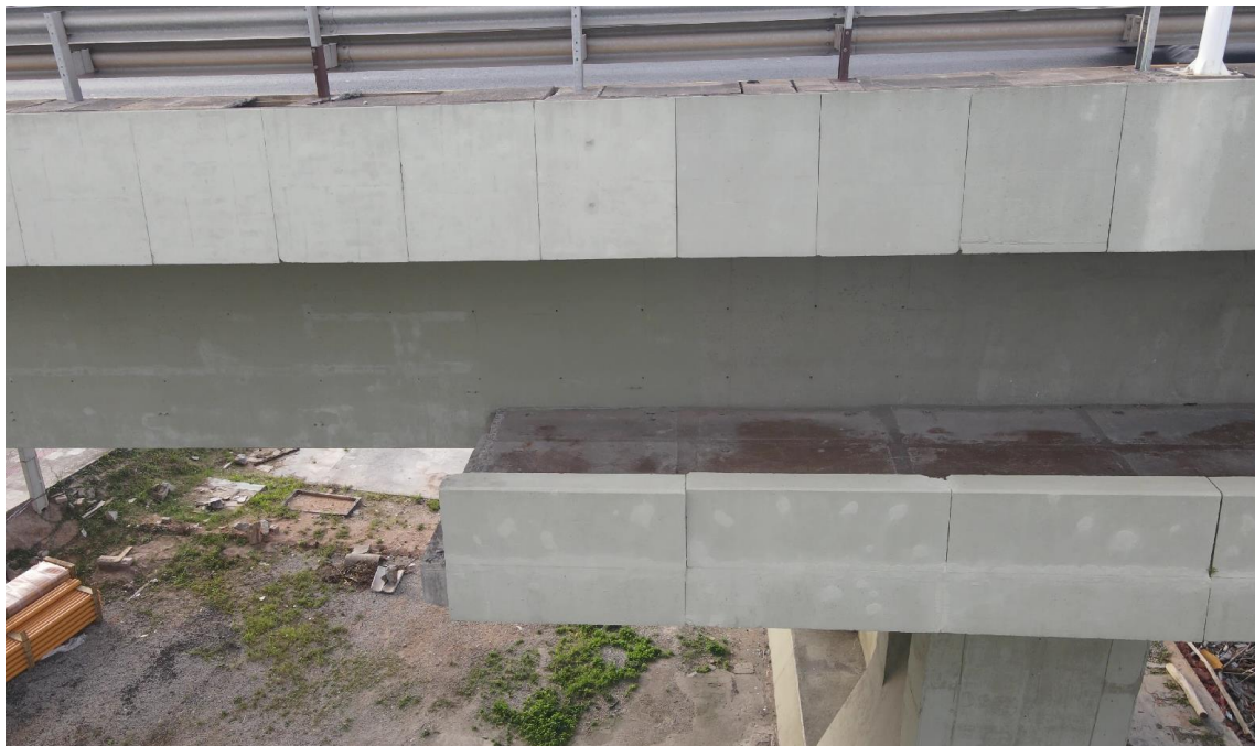
Figura 18 - Início da passarela na extremidade continental, lado sul, com todos os componentes
