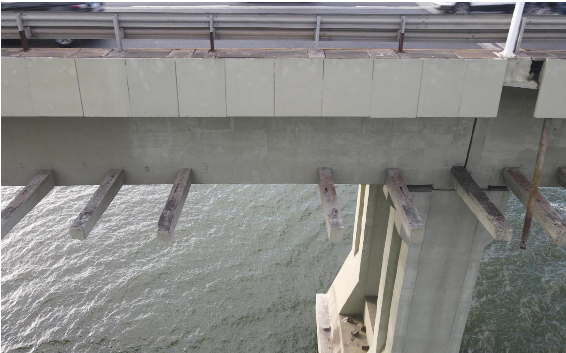
Figura 22 - Vigas ausentes no trecho, além de ausência de placa no sistema de drenagem
