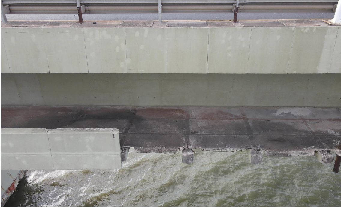
Figura 19 - Transição da descontinuidade dos elementos de guarda-corpo, lado sul da passarela
