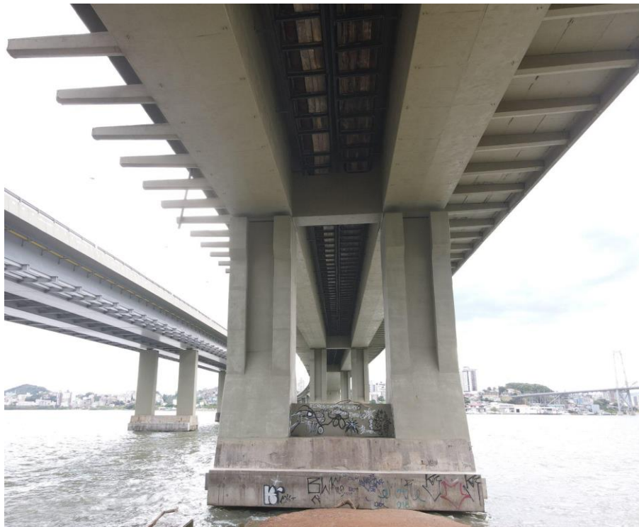
Figura 7 - ILHA - Ponte Colombo Machado Salles: lado sul (esq.), constam apenas as vigas pré-moldadas, lado norte (dir.) passarela completa.
