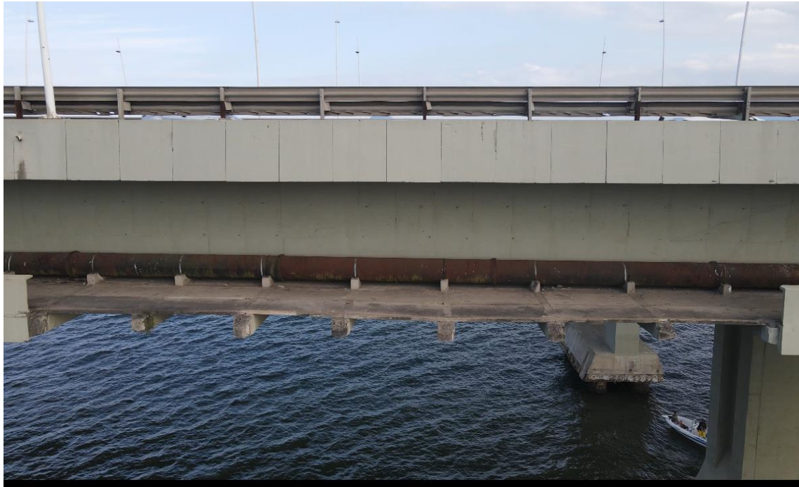
Figura 12 - Sete placas de guarda-corpo ausente no vão entre Bloco 5 e Bloco 6
