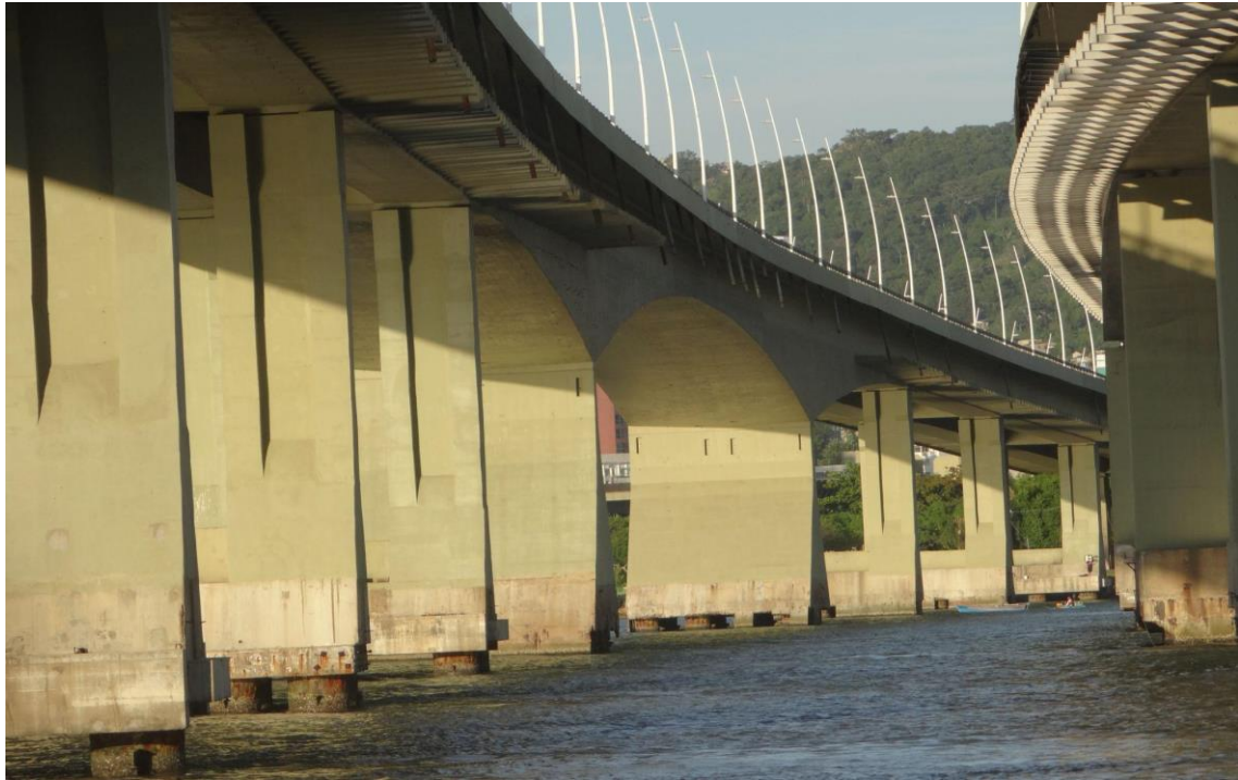
Figura 28 - Vista lateral da configuração das vigas caixão da ponte CMS, exibindo as vigas independentes, viga caixão central e retomada das vigas independentes
