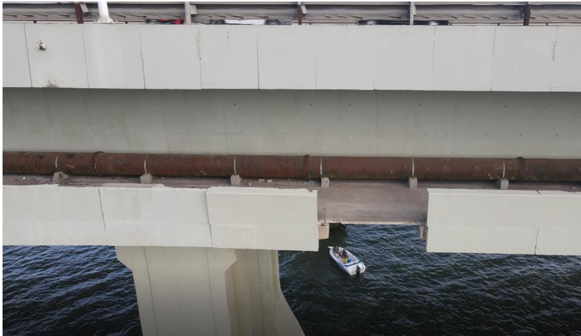
Figura 13 - Placa de guarda-corpo ausente próxima ao eixo do Bloco 5
