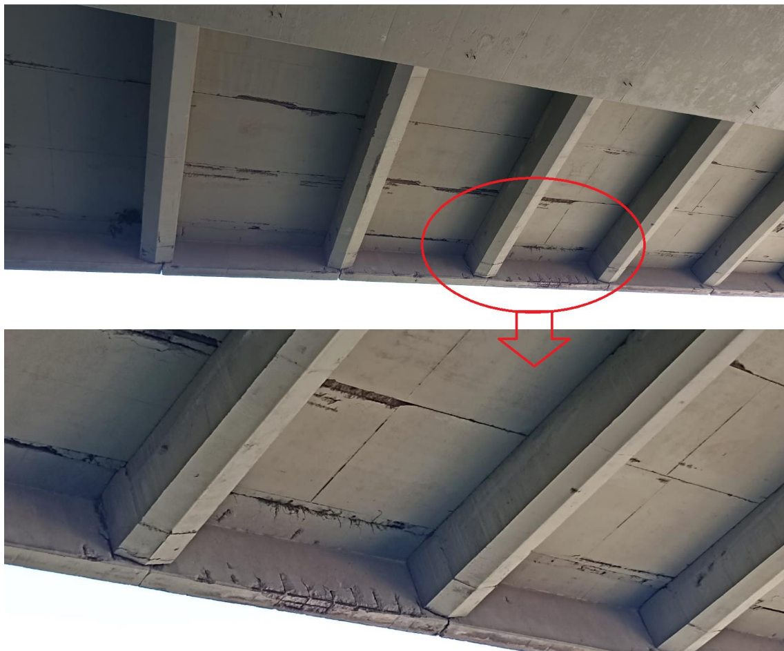
Figura 16 - Manifestações patológicas na passarela (lado norte) sobre a via, na extremidade continental
