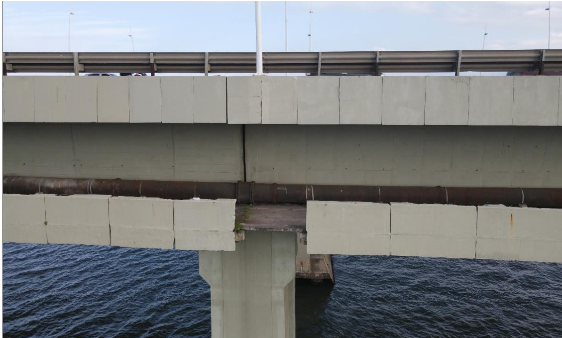
Figura 11 - Placa de guarda-corpo ausente no eixo do Bloco 6
