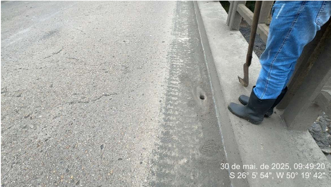
Imagem 50 - Dreno sobre tabuleiro (pista).
