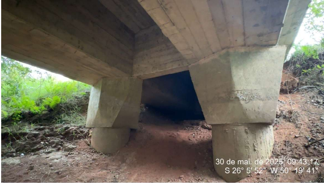
Imagem 49 - Pilares do apoio 1.
