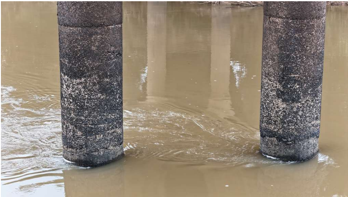
Imagem 44 - Pilares do apoio 3.
