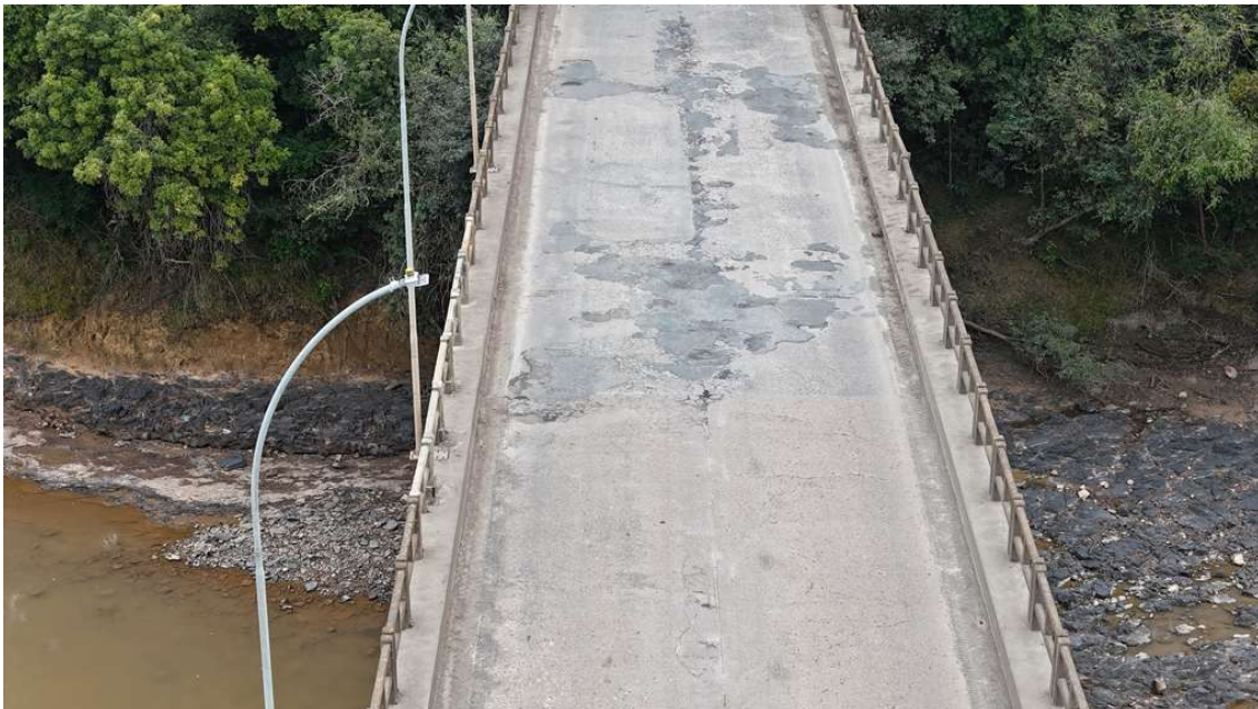
Imagem 6 - Manifestações patológicas no pavimento da ponte.
