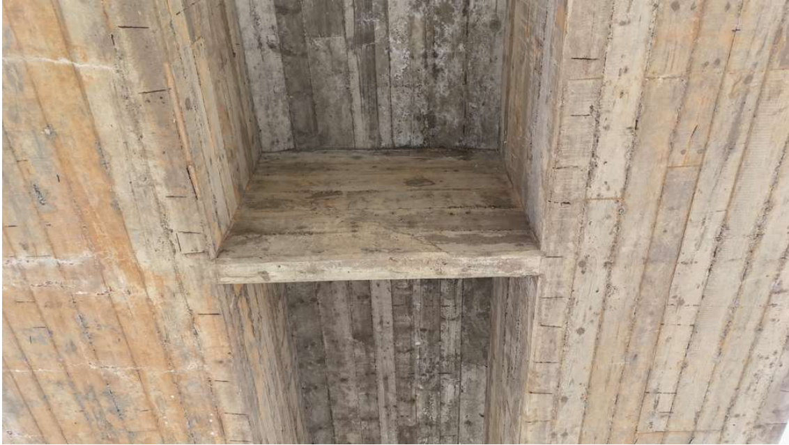
Imagem 47 - Falta de recobrimento nas armaduras da superestrutura.
