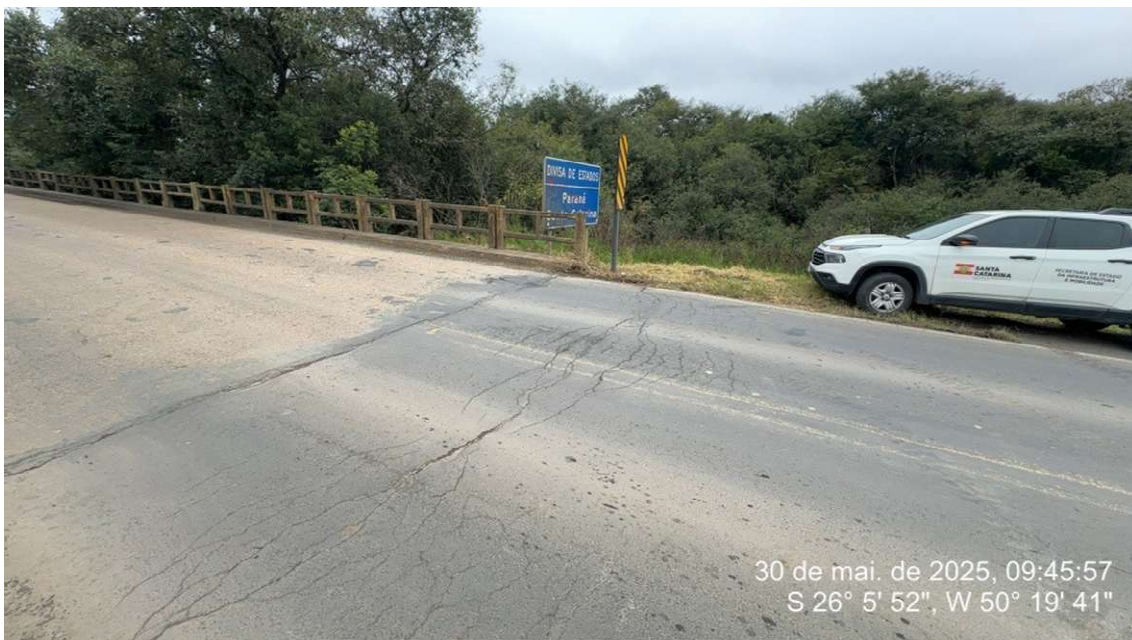
Imagem 4 - Manifestações patológicas na cabeceira da ponte, município de São Mateus do Sul. Ausência da laje de transição.
