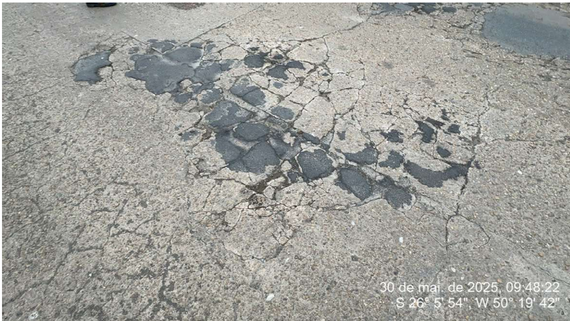
Imagem 8 - Manifestações patológicas no pavimento da ponte.
