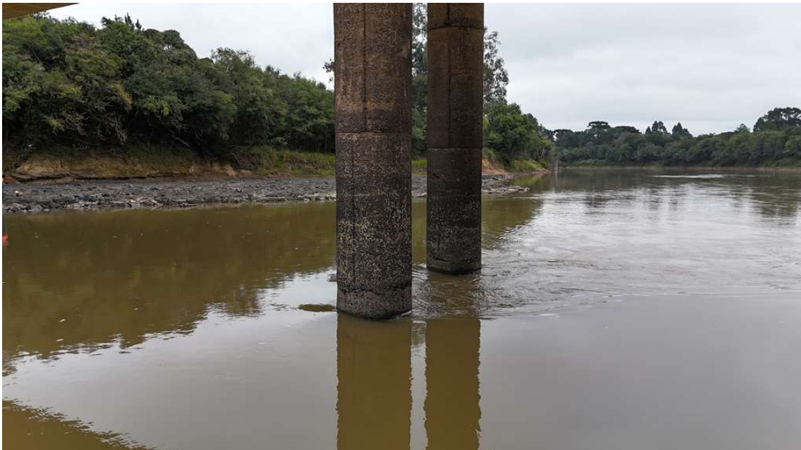
Imagem 40 - Pilares do apoio 3.
