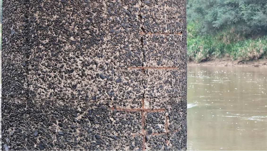
Imagem 31 - Armadura exposta e trincas.
