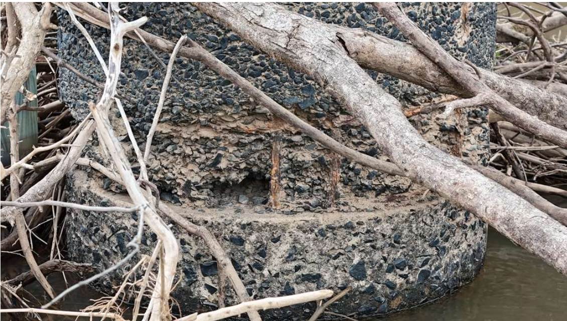
Imagem 32 - Perda de seção do concreto.
