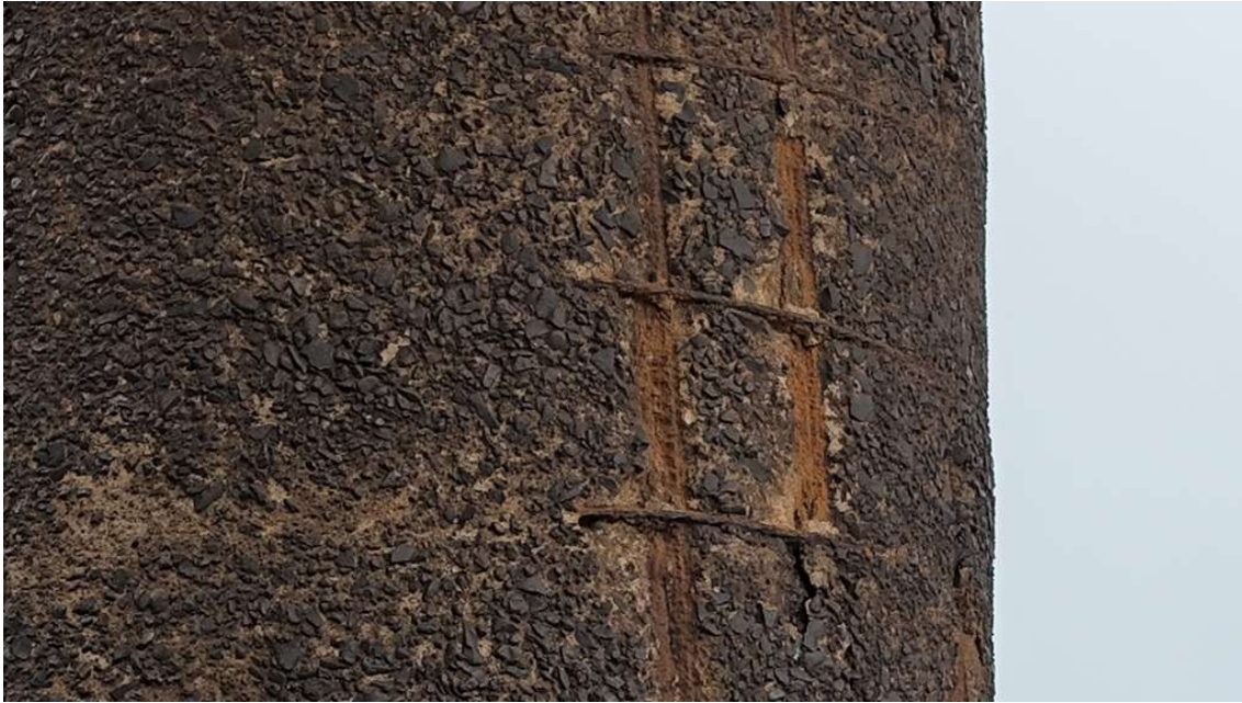
Imagem 25 – Armadura exposta em pilar.
