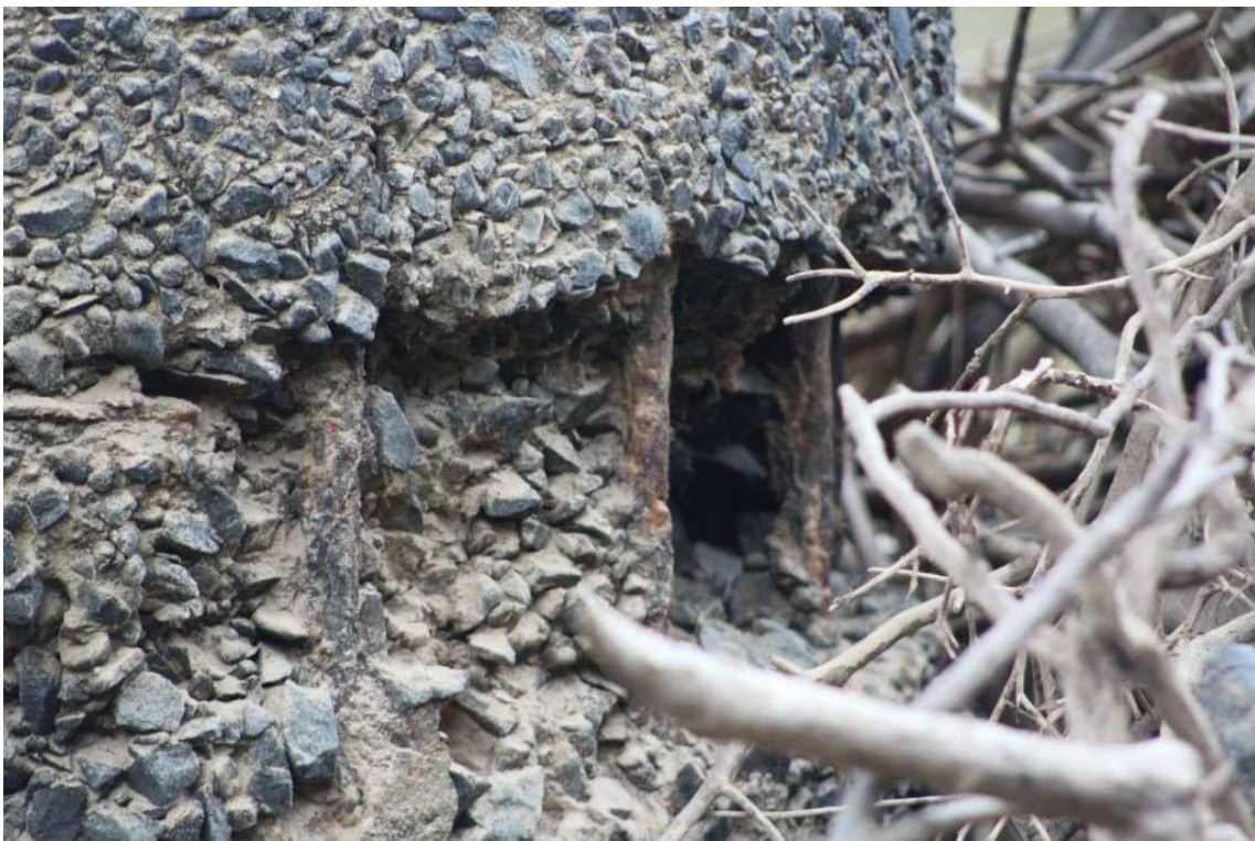
Imagem 36 - Perda de seção do concreto.
