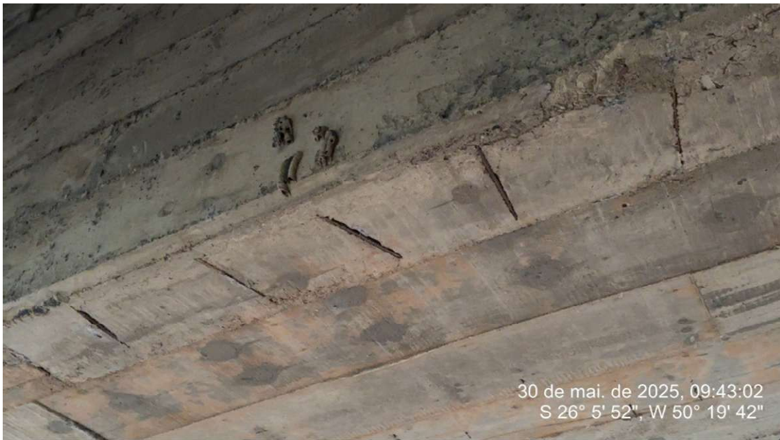
Imagem 24 - Falha no recobrimento da armadura.
