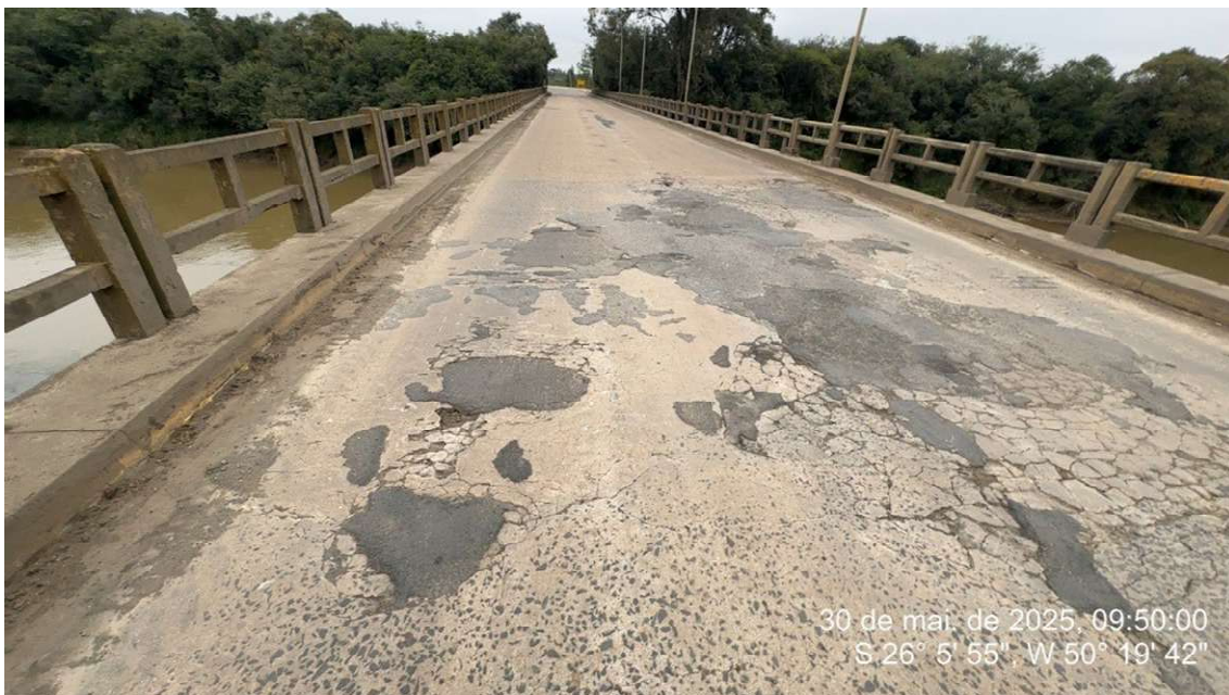
Imagem 10 - Manifestações patológicas no pavimento da ponte.
