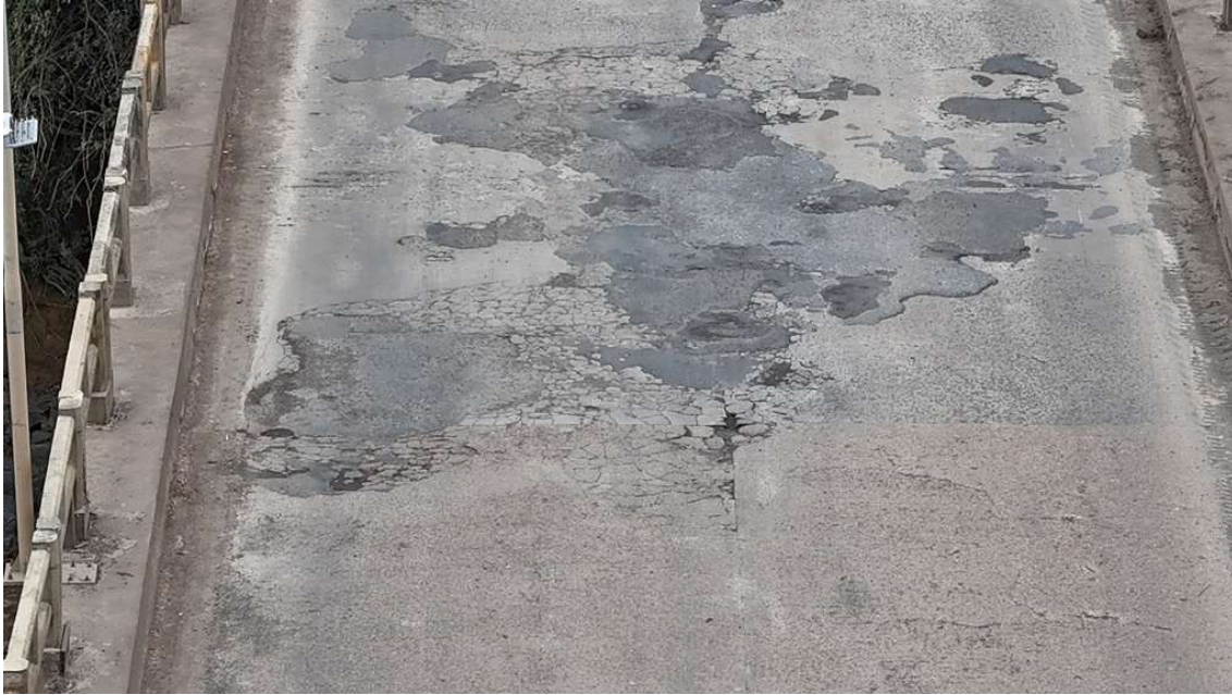
Imagem 5 - Manifestações patológicas no pavimento da ponte.
