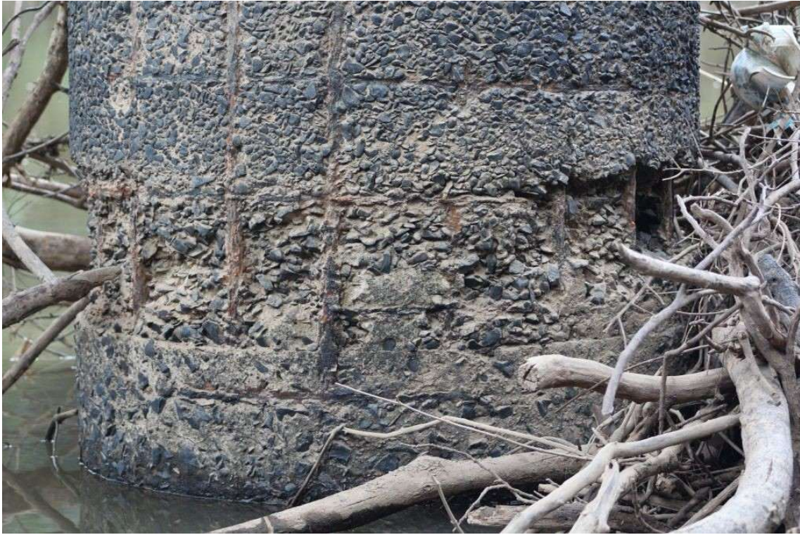
Imagem 35 - Perda de seção do concreto.
