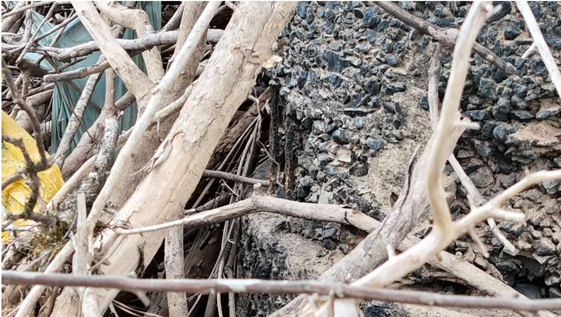
Imagem 33 - Perda de seção do concreto.
