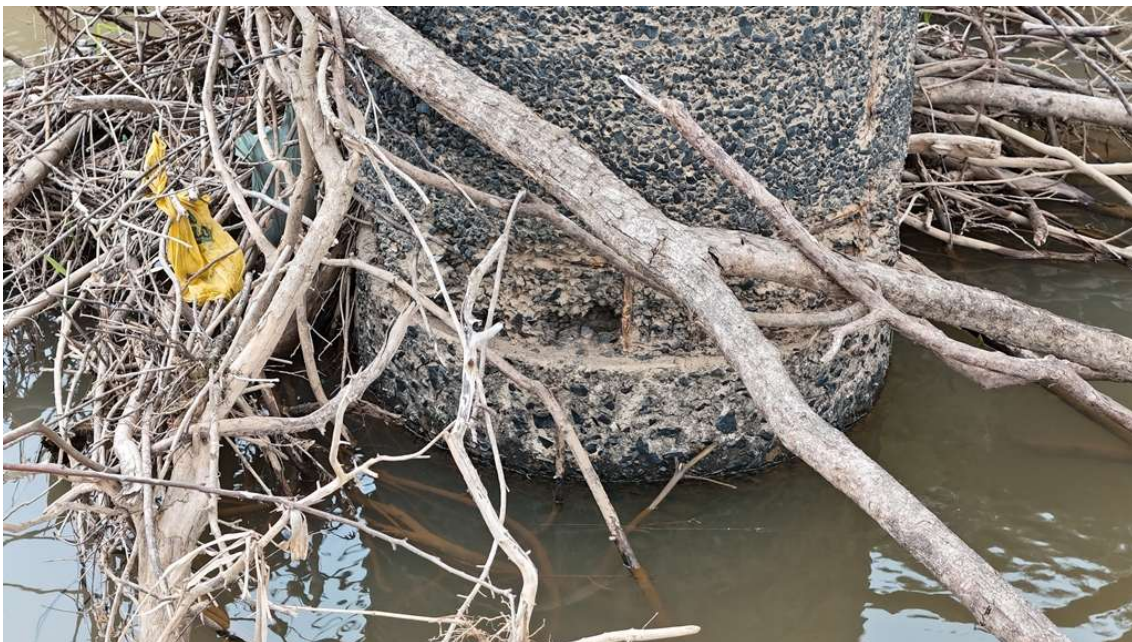
Imagem 34 - Perda de seção do concreto.
