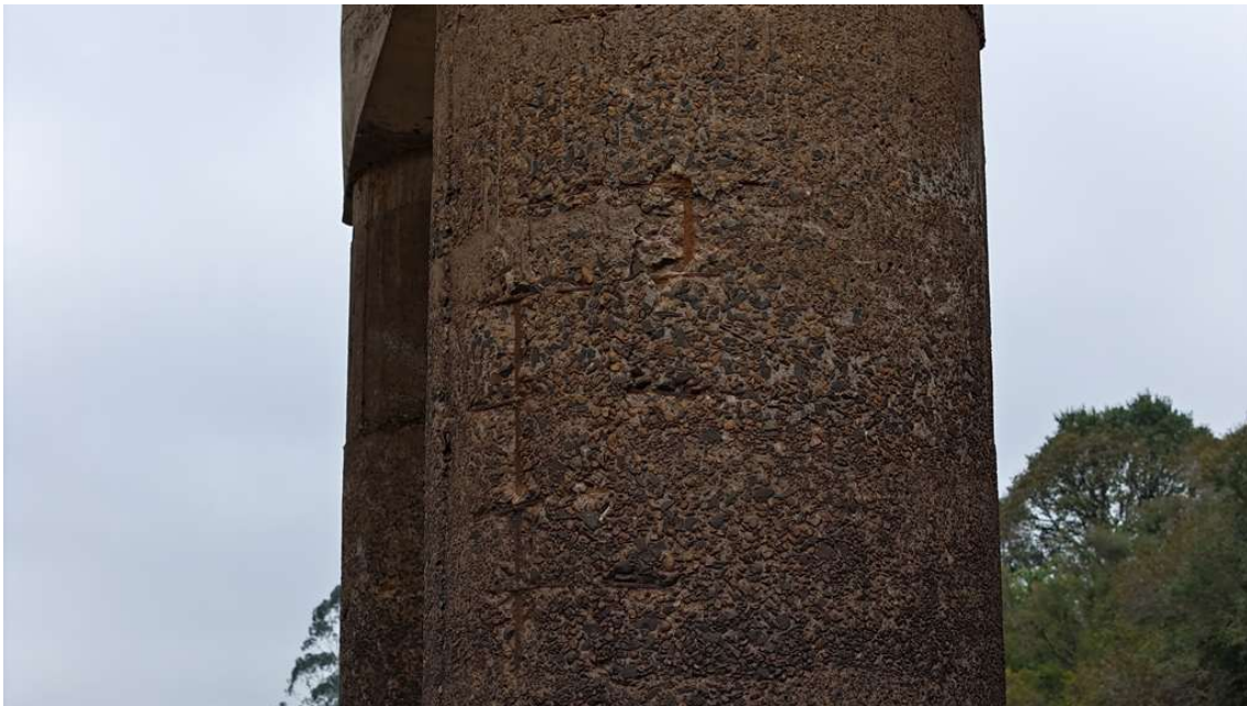
Imagem 26 - Armadura exposta em pilar.
