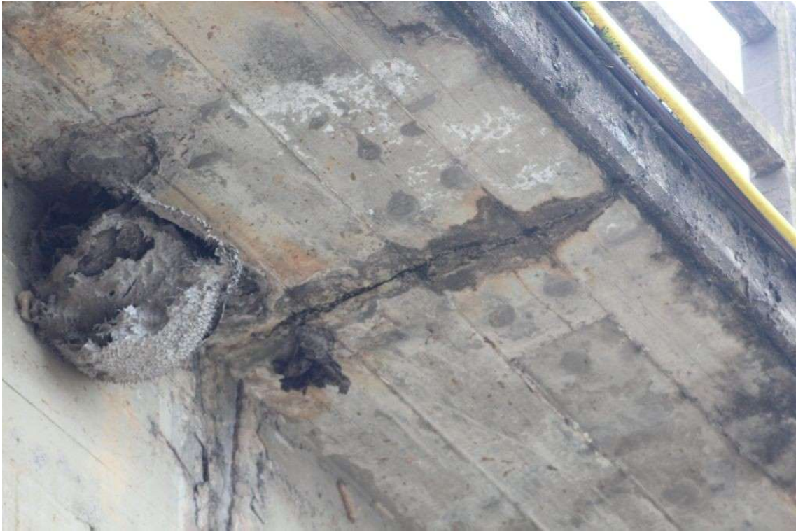
Imagem 23 - Infiltrações na superestrutura.
