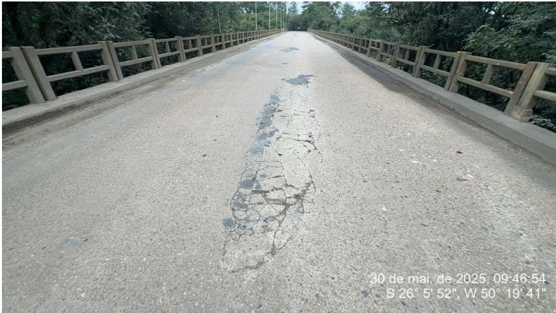
Imagem 7 - Manifestações patológicas no pavimento da ponte.
