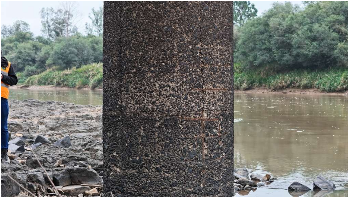
Imagem 30 - Armadura exposta em pilar.
