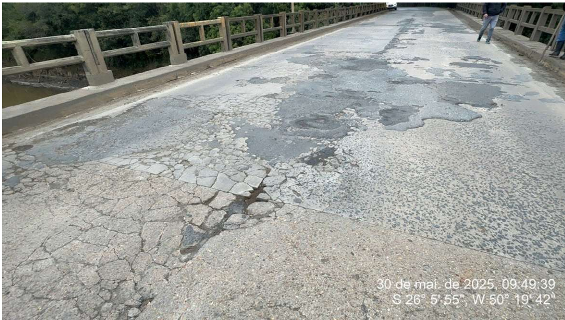
Imagem 9 - Manifestações patológicas no pavimento da ponte.
