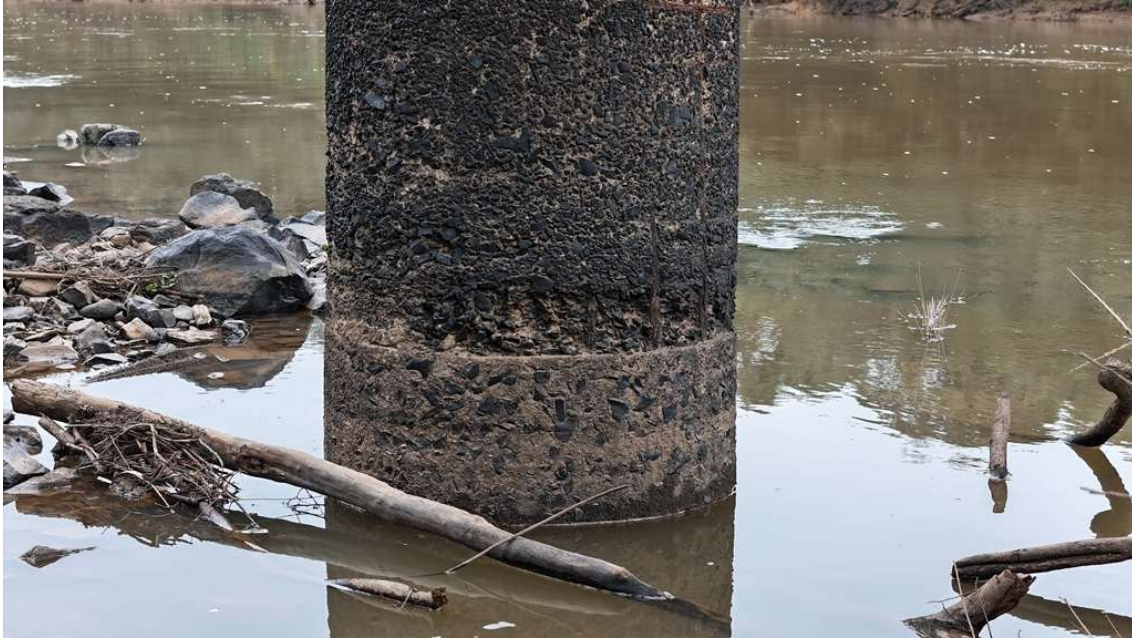
Imagem 29 - Perda de seção nos pilares no apoio 4.
