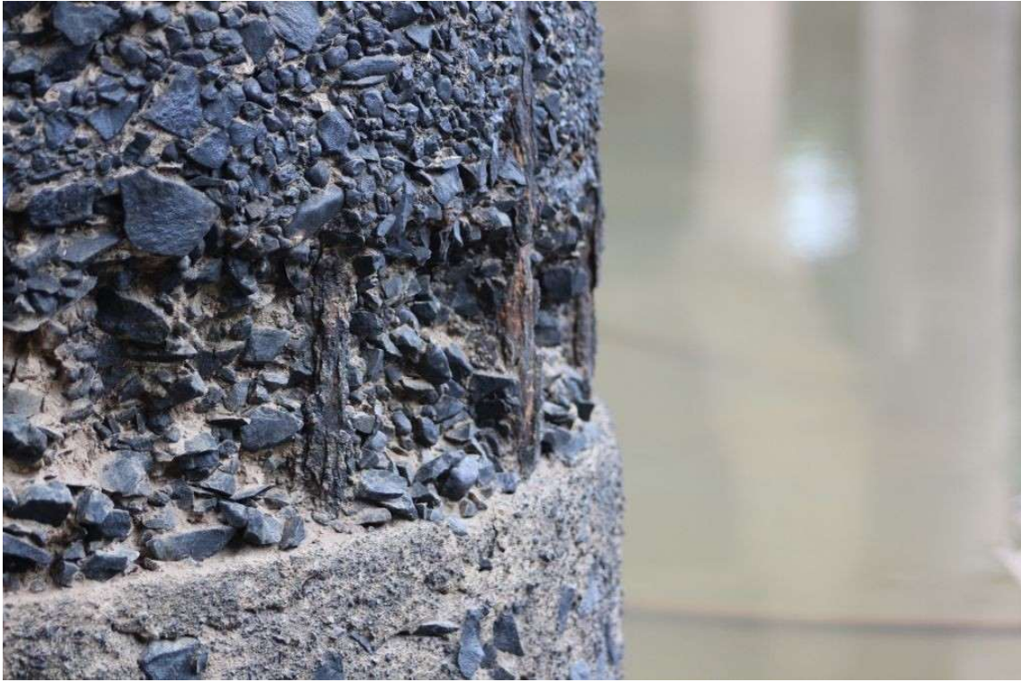
Imagem 37 - Desagregação de concreto em pilar do apoio 4.
