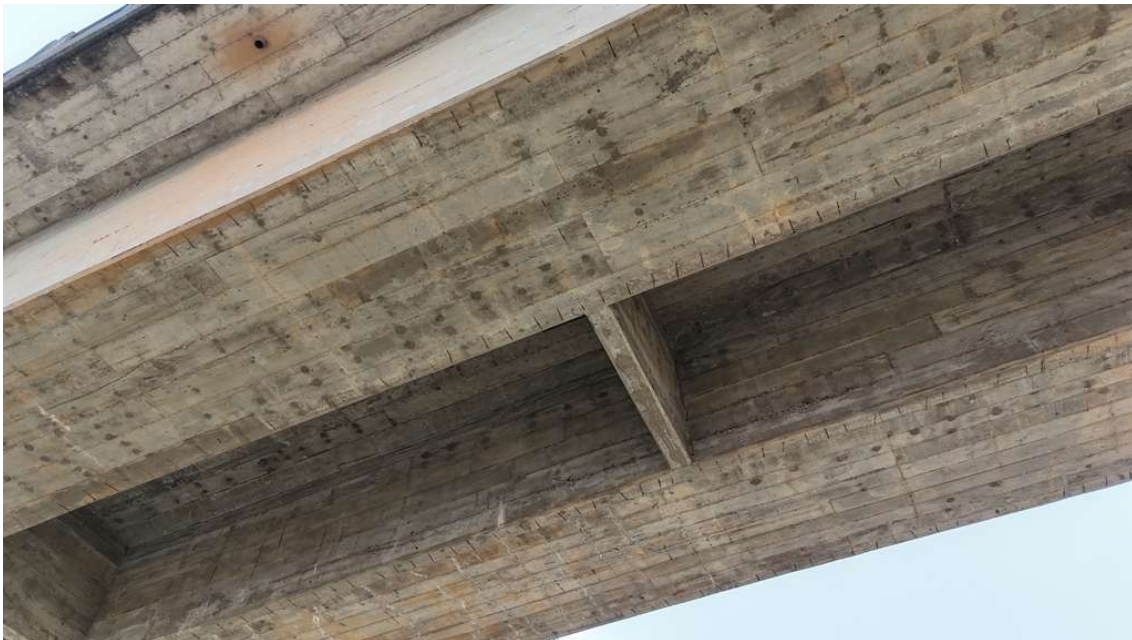
Imagem 48 - Falta de recobrimento nas armaduras da superestrutura.
