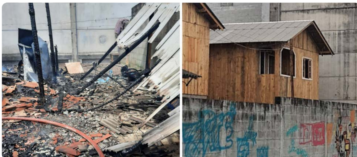
Essa casa pegou fogo durante o processo de seleção das residências apoiadas e também foi reconstruída.
