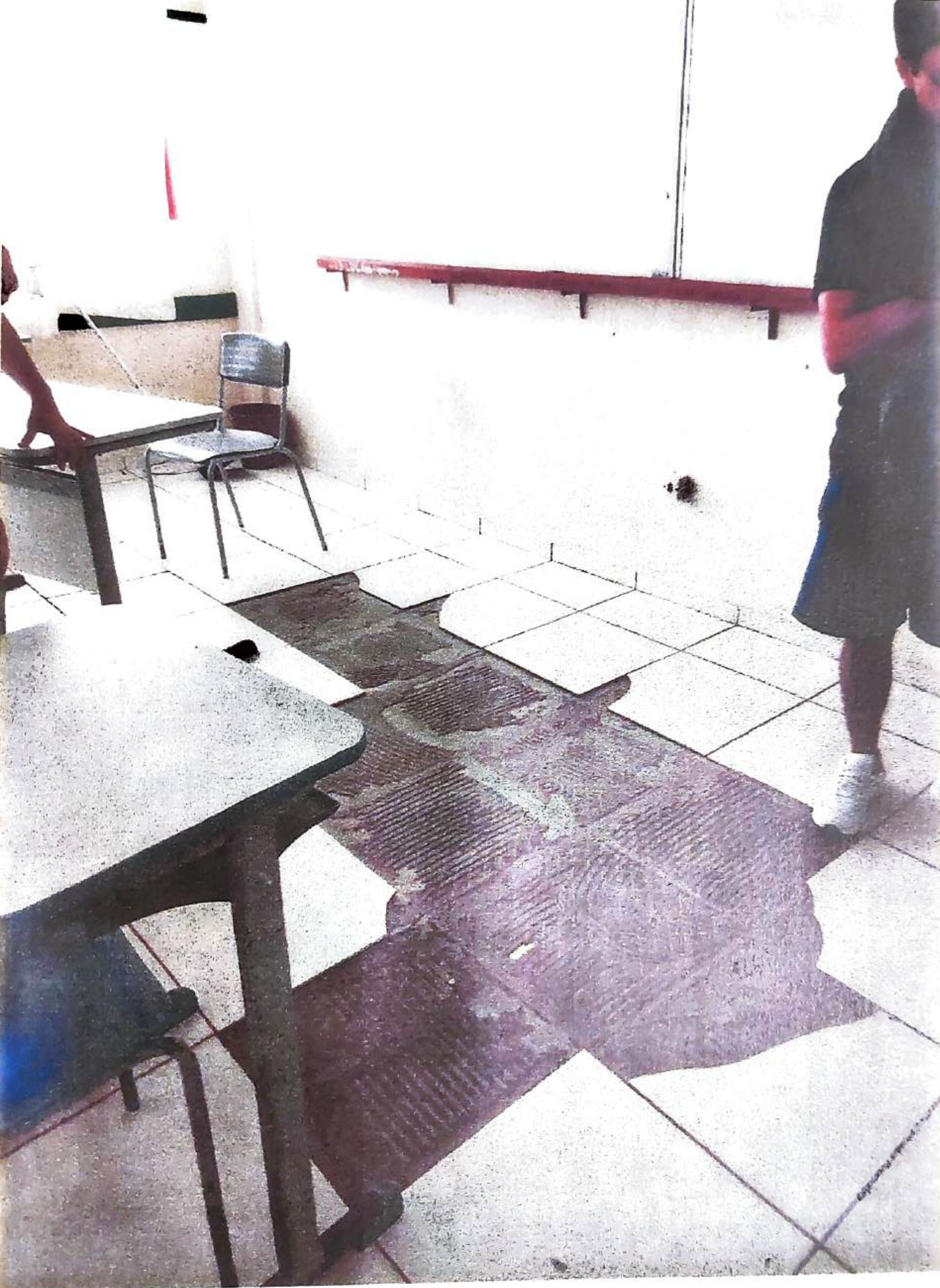
Pisos das últimas salas de aula que foram construídas descolando do chão (são 3 salas com o mesmo problema).
