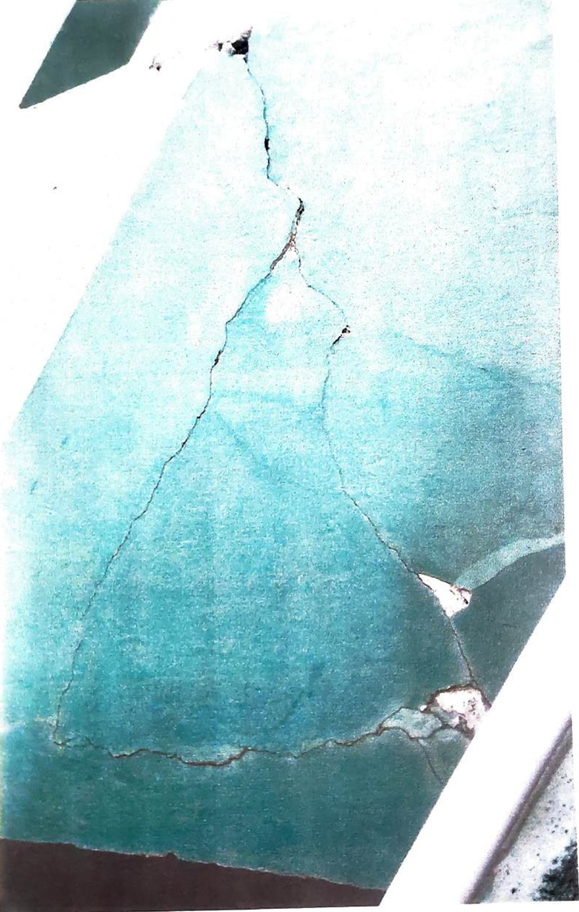
Rachadura no muro de grande extensão no muro da porta principal da escola (escadaria)
