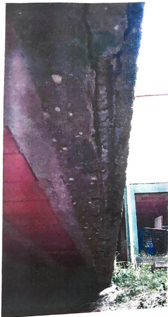
Estrutura de ferro exposta embaixo do refeitório
