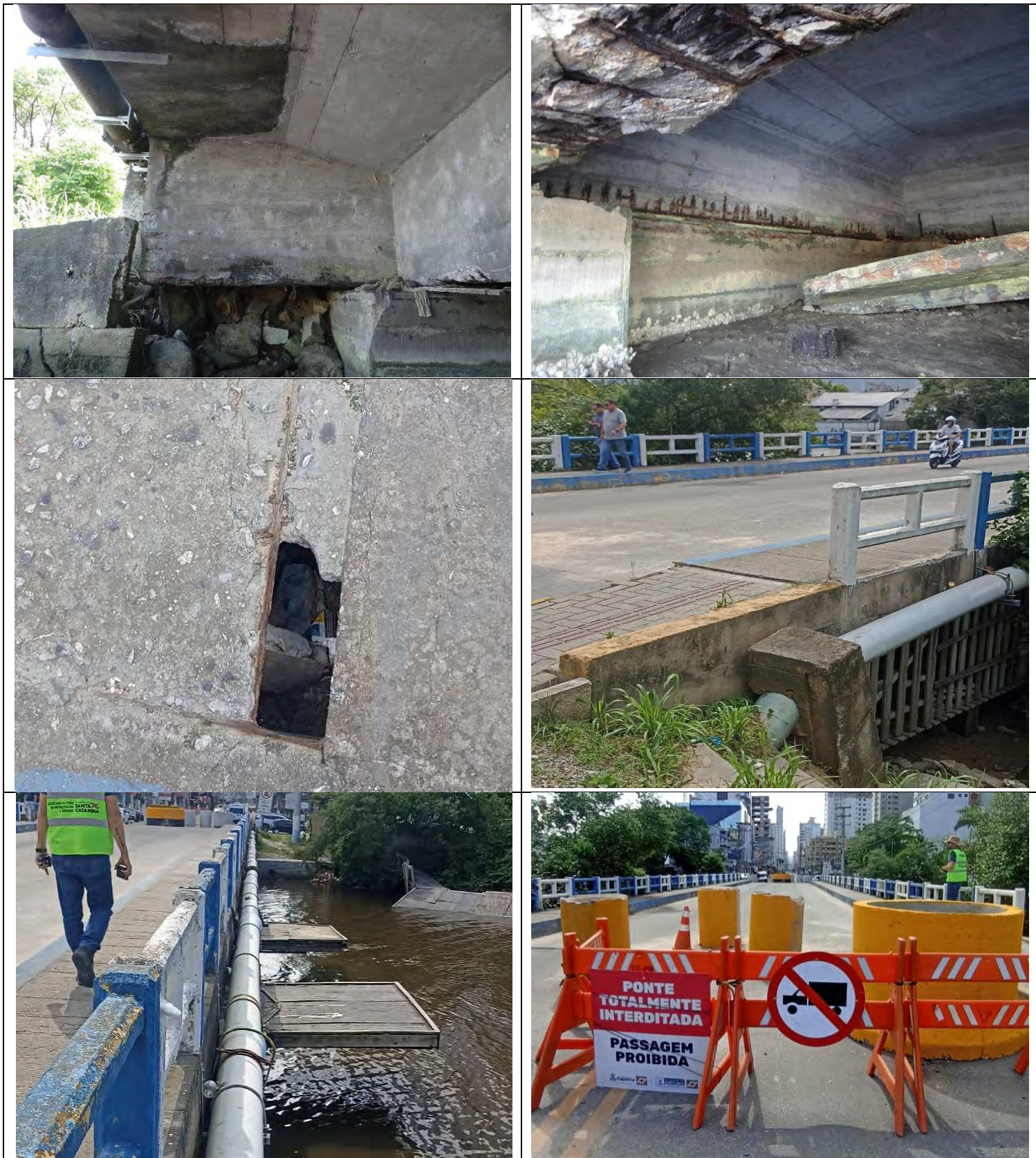
Figura 6 - Face sudoeste: I. Vista frontal da ala e encontro/ II. Vista da travessa de encontro entre os blocos do eixo 5/ III. Buraco no passeio/ IV. Vista lateral da cabeceira à nordeste / V. Vista de cima da ponte da face nordeste / VI. Sinalização de interdição da OAE
