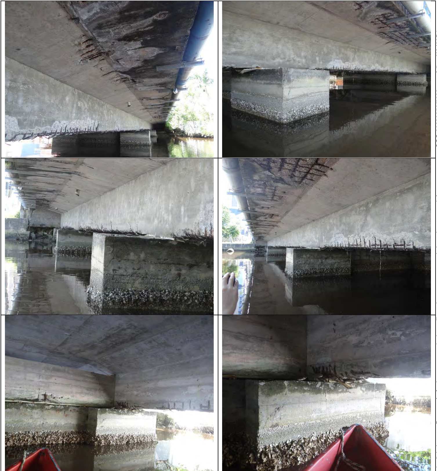
Figura 5 - Face sudoeste: I, II, III, IV. Vista lateral da ponte. / V e VI. Viga com estribos comprometidos no apoio e bloco de coroamento 4 fissurado
