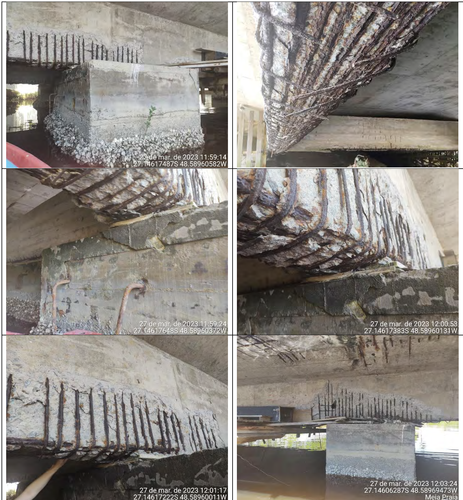
Figura 2 - Face nordeste: I. vista lateral do Apoio 2, com barras longitudinais e estribos rompidos e fissuras no bloco de coroamento / II. viga entre apoio 1 e 2 corroída e com todos os estribos rompidos / III. IV. e V. mais detalhes do apoio 2 / VI. apoio 3 com estribos rompidos, armadura exposta e corroída, concreto deslocado
