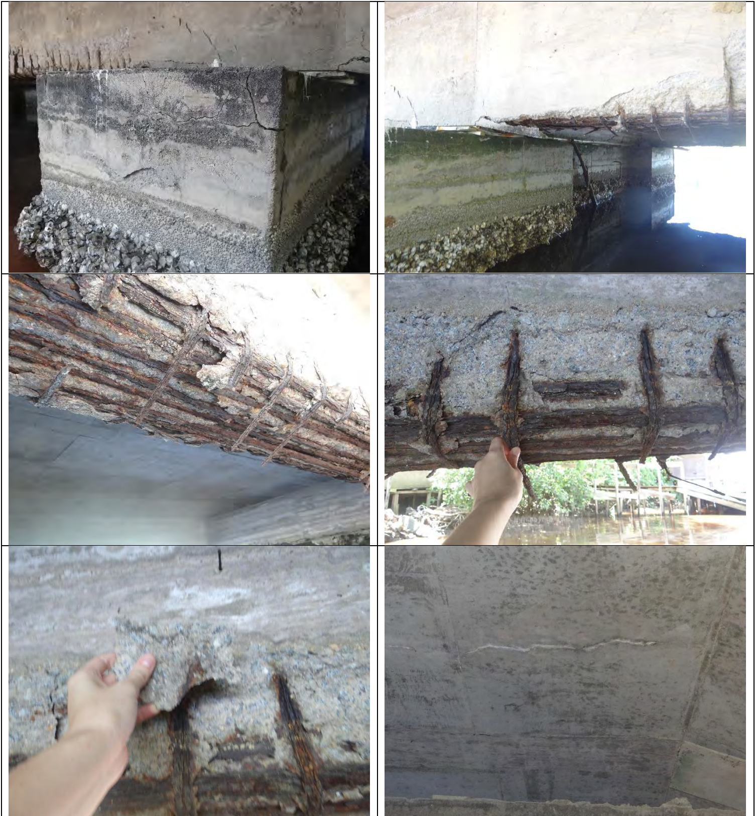
Figura 3 - Face nordeste: I. Fissuras no bloco de coroamento 4, concreto deslocado no apoio e armaduras expostas / II. Vista blocos eixo 4 / III e IV. Viga entre blocos de coroamento 4 e 5 com estribos totalmente rompidos, barras longitudinais expostas, corroídas e comprometidas / V. Viga entre bloco 4 e 5 com concreto soltando, deslocando / VI. Eflorescência em laje entre blocos 4 e 5
