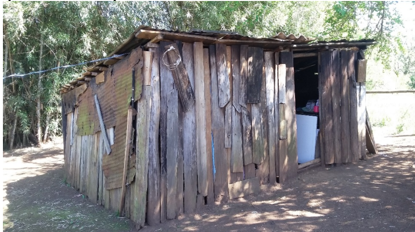
Figura 1 – Exemplo de Moradia precária no Estado de Santa Catarina – Município de Ipuçu
