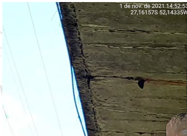
Foto 26 – Fissuras no Bordo - Jusante
