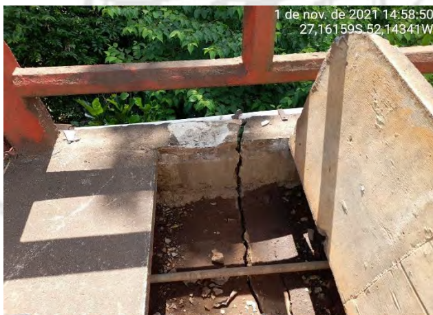
Foto 34 – Fissuras / Trincas - Tabuleiro
