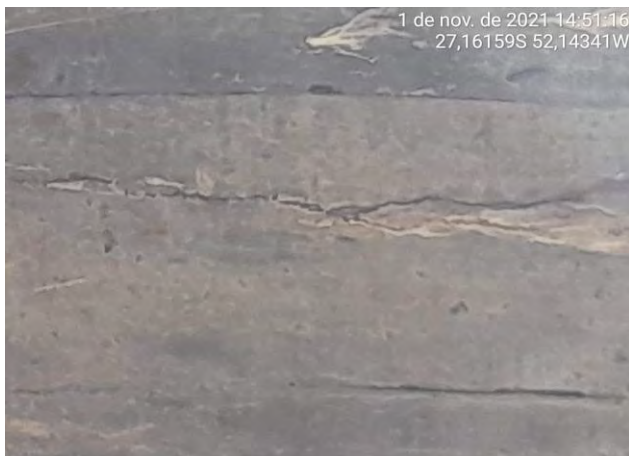
Foto 25 – Fissuras na Laje Central
