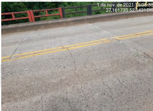
Foto 23 – Fissuras na Pista de Rolamento
