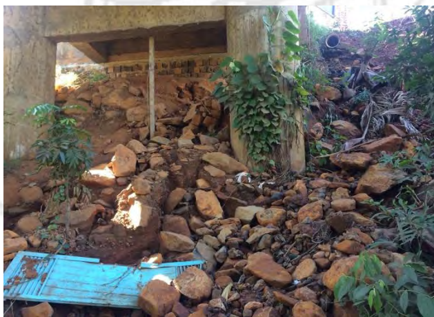
Foto 04 – Talude sem o Aterro Lateral
