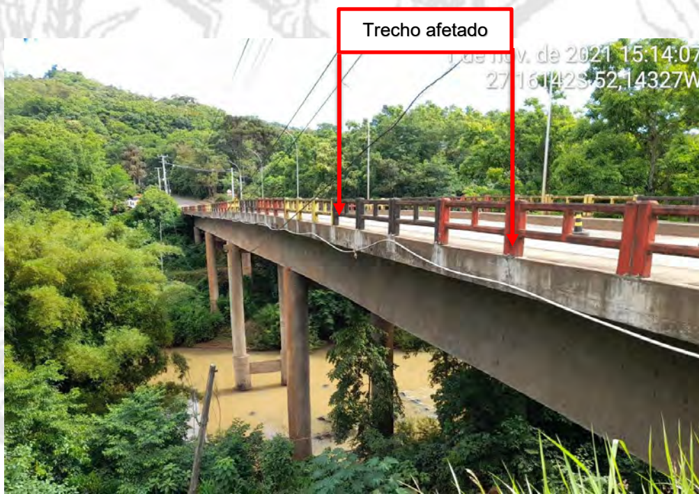
Foto 20: Região onde apresentam-se maior número de fissuras
