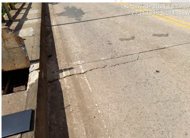
Foto 21 – Fissuras na Pista de Rolamento
