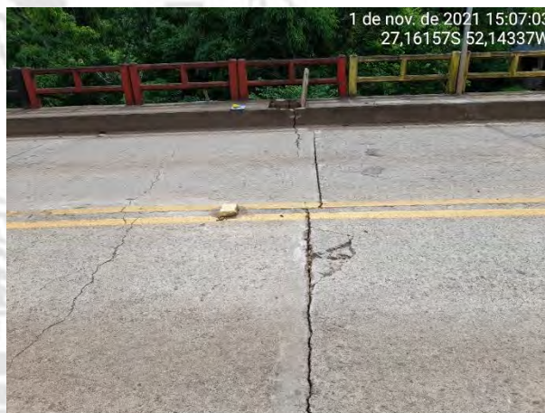
Foto 22 – Fissuras na Pista de Rolamento
