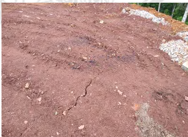
Foto 06 – Aterro Lateral – Sem compactação
