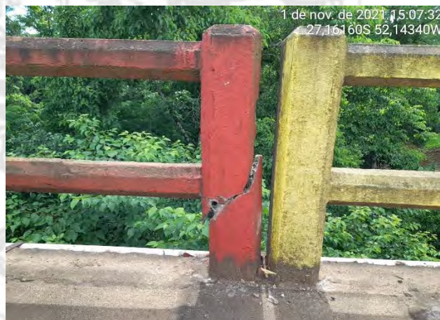
Foto 35 – Rompimento do Guarda Corpo
