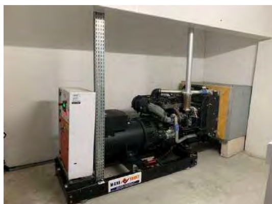
F29 – Subsilo – grupo gerador de energia
