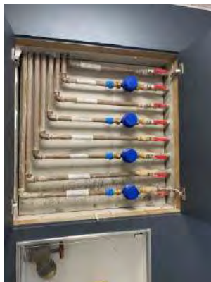
F53 – 6º Pav. – hidrômetros
