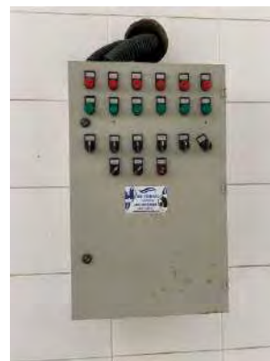
F26 – Subsilo – estação tratamento esgoto, quadro de comando de bombas
