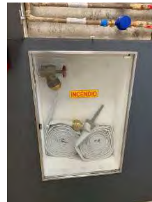
F54 – 6º Pav. – hidrante de incêndio
