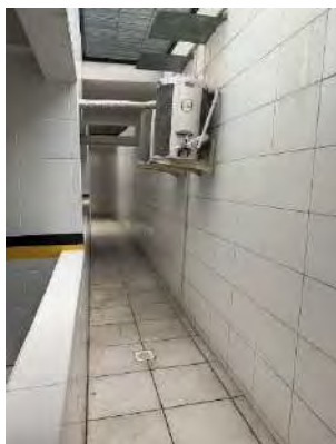
F25 – Subsilo – estação tratamento esgoto
