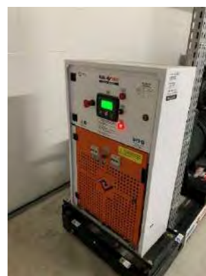
F30 – Subsilo – grupo gerador de energia, quadro de comando
