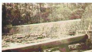
1951: Tubulação Salto Flor do Mato
