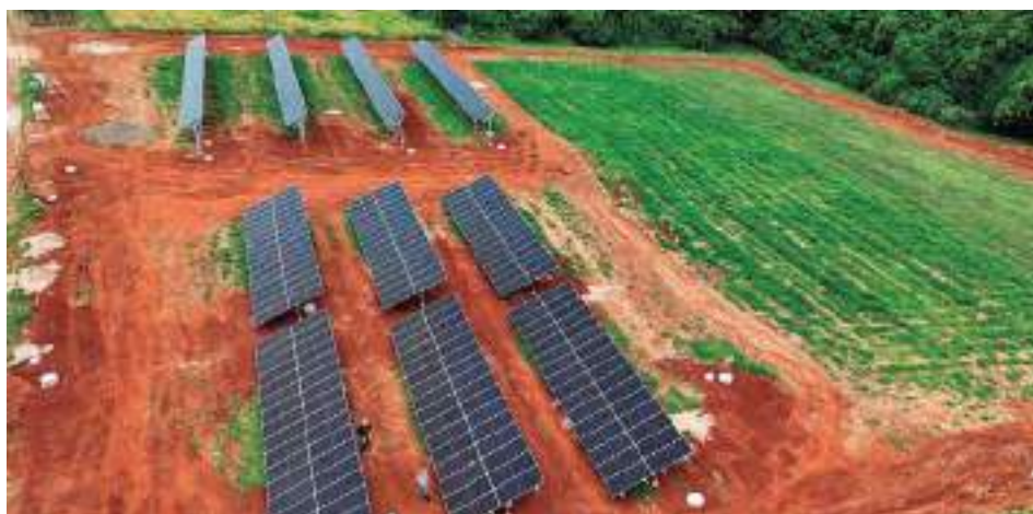
VISTA DO SISTEMA AGRIVOLTAICO EM IMPLEMENTAÇÃO NO CAMPUS DE PIRACICABA FOTO: DIVULGAÇÃO
