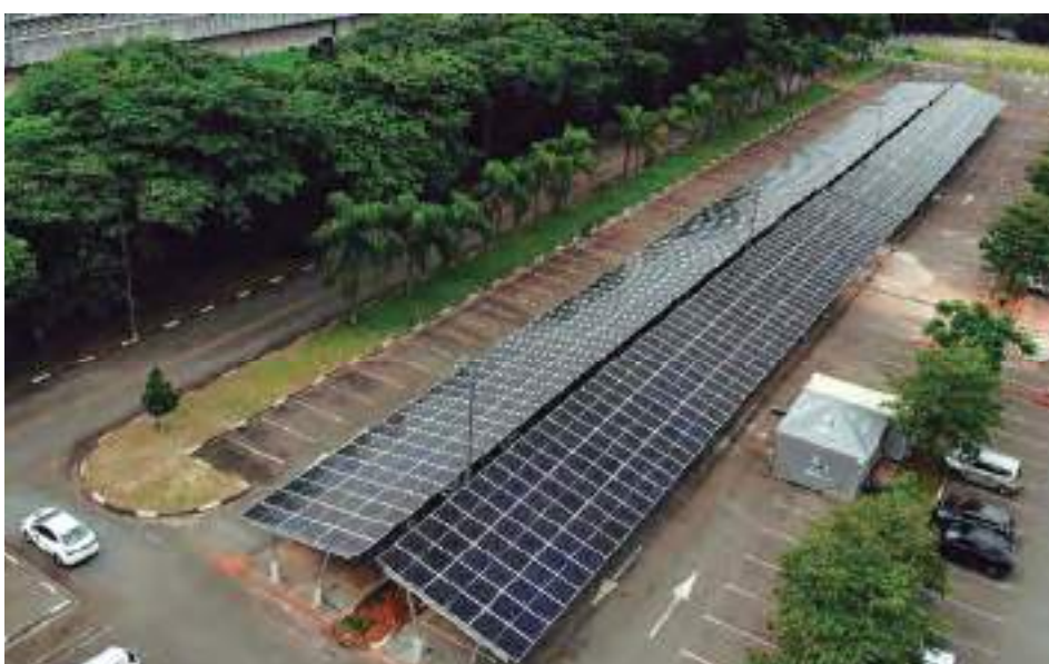
SISTEMA SOLAR INSTALADO NA ESCOLA DE ARTES, CIÊNCIAS E HUMANIDADES FOTO: DIVULGAÇÃO
