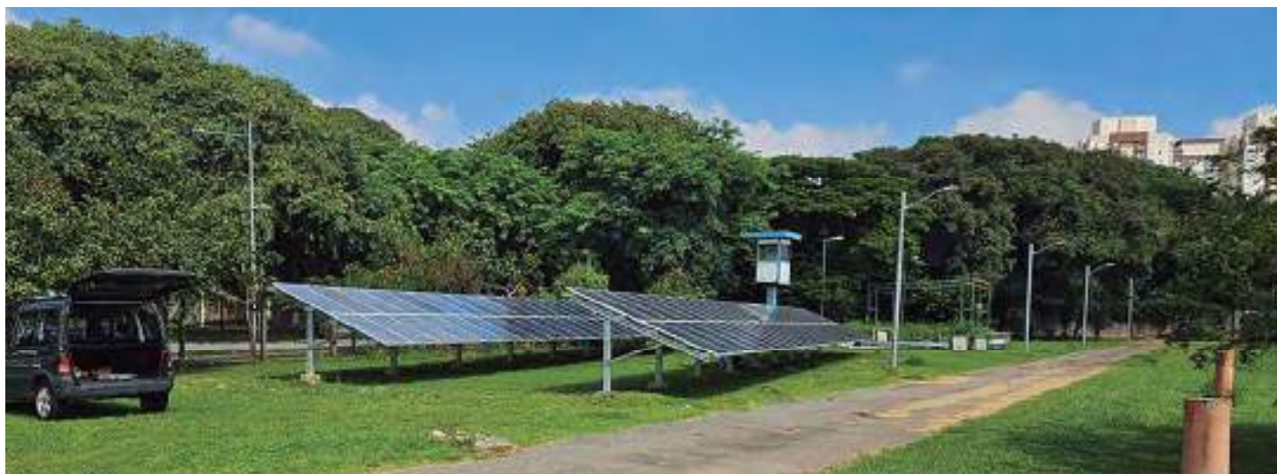
VISTA DO SISTEMA SOLAR INSTALADO NA RAIA DA USP, NA CIDADE UNIVERSITÁRIA FOTO: DIVULGAÇÃO
