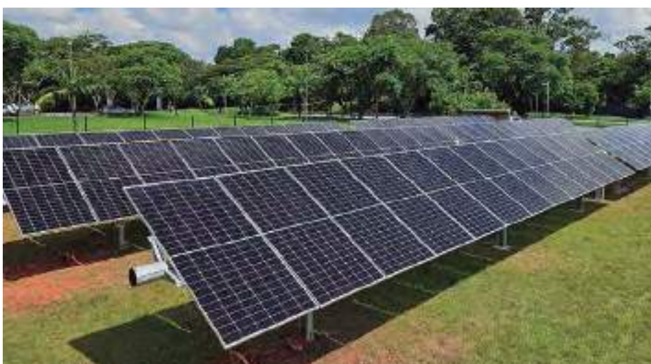
SISTEMA SOLAR INSTALADO NA FRENTE DO EDIFÍCIO ICB IV, NA CIDADE UNIVERSITÁRIA FOTO: DIVULGAÇÃO
