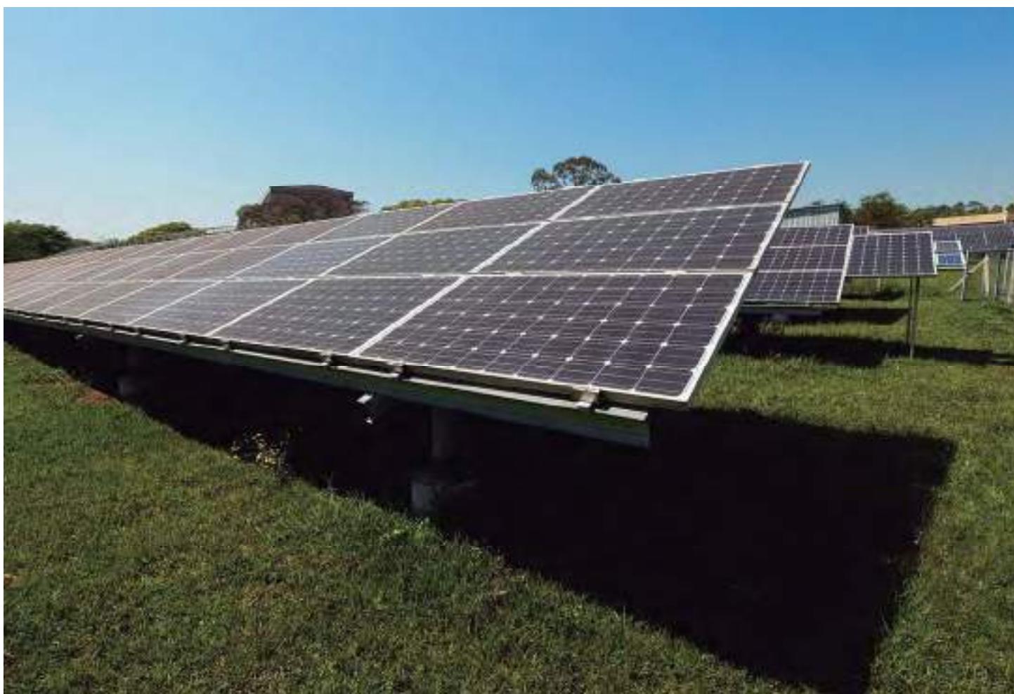
USINA SOLAR FOTOVOLTAICA DE 540 KW DO INSTITUTO DE ENERGIA E AMBIENTE, NA CIDADE UNIVERSITÁRIA FOTO: MARCOS SANTOS/USP IMAGENS
