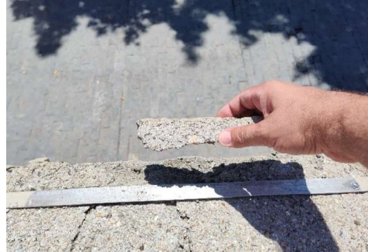
Fotografia 22 – Dessegregação da proteção mecânica da laje
