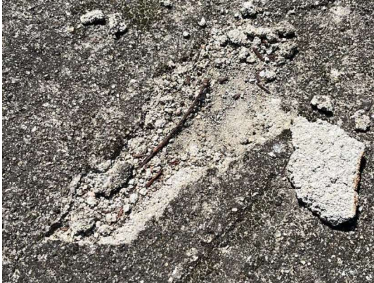
Fotografia 21 – Dessegregação da proteção mecânica da laje
