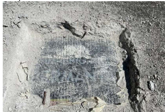
Fotografia 40 – Dessegregação da proteção mecânica da laje
