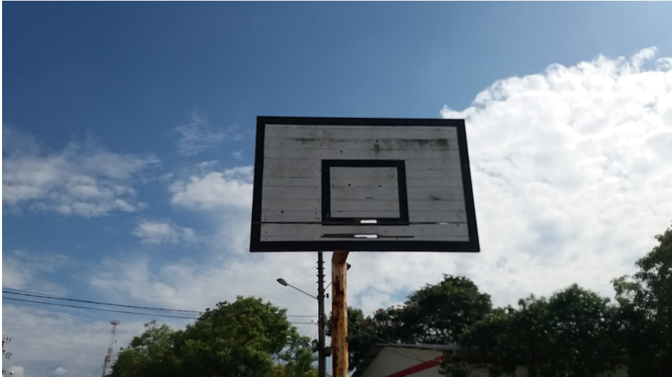
Foto 3: Deterioração das tabelas de basquete.
