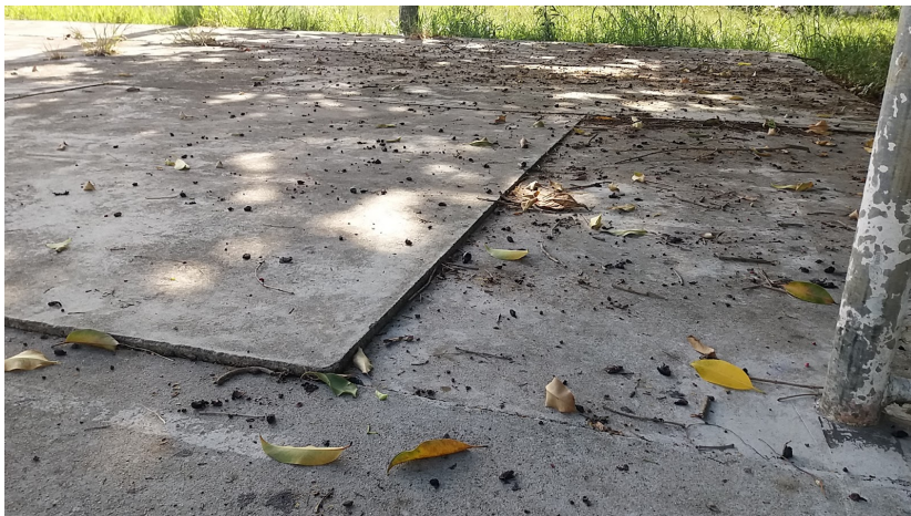
Foto 2: Irregularidades no piso da quadra.
