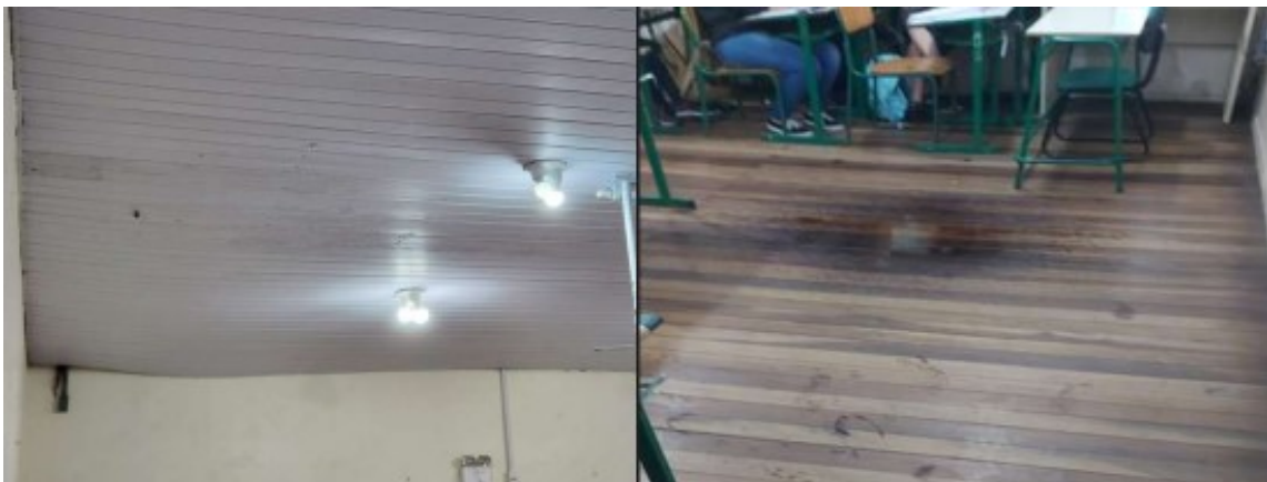
Forro salas de aula e corredores (locais com infiltração)
